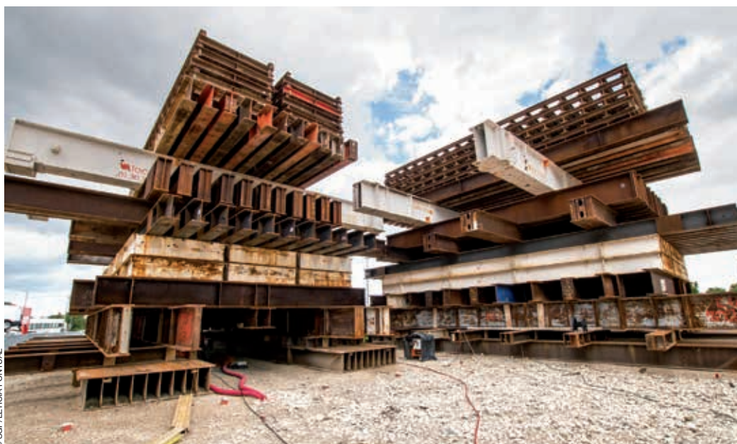
Deux des trois amas de poutres en acier simulant des bâtiments avec fondations au-dessus du passage du tunnelier.
