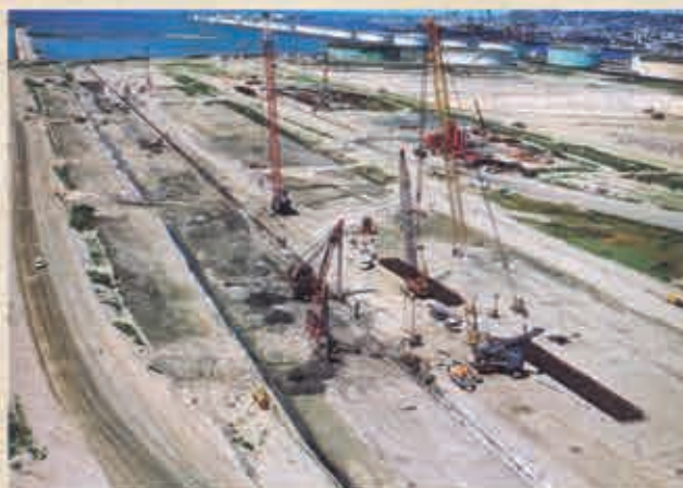
Photo 1 Réalisation de la paroi moulée formant le quai Construction of the diaphragm wall forming the quay
