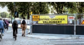
Entrée du chantier d'assainissement récompensé, situé à proximité de la gare d'Austerlitz, à Paris.
