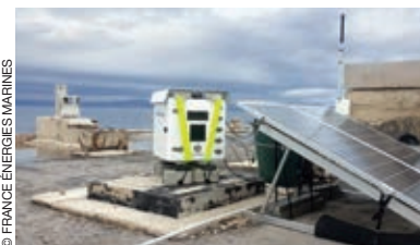
Dispositif de télédétection installé sur l'île de Planier dans le golfe du Lion, pour mesurer la turbulence du vent.
