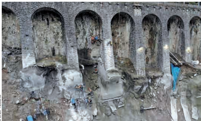
Mur à arcatures en travaux, après la tempête Alex dans la Vallée de la Roya, le 3 octobre 2020.
