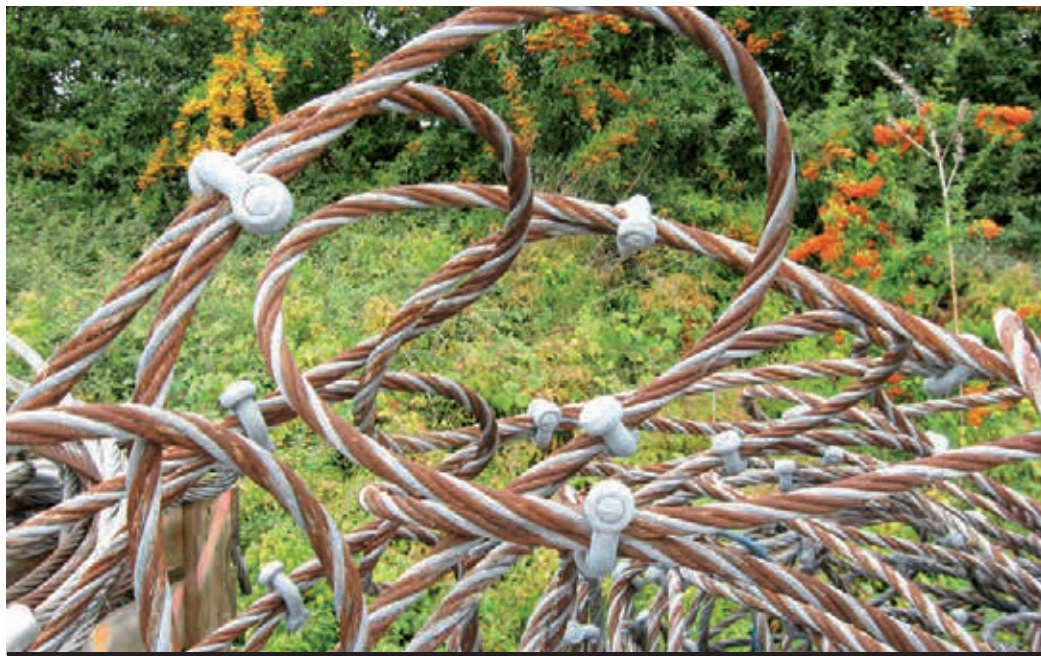
En 2007, des câbles ont été corrodés par manque de zinc lors de la galvanisation de l'acier.
