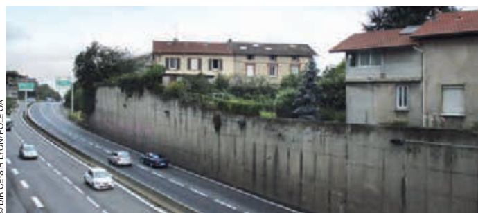
Le mur de soutènement Guizay 2 (Loire) sur la RN 88 fait l'objet d'investigation pour trouver l'origine des fissures et éclats qui témoignent de son instabilité.
