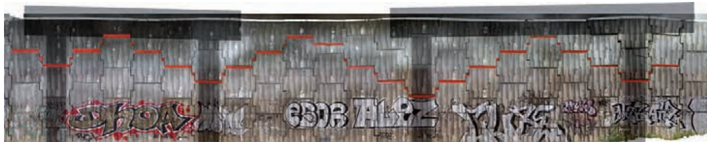
En rouge, les écarts entre écaïlles sur la culée du viaduc de Lyons à Rouen (Seine-Maritime). En surimpression, les piliers et le chevêtre.
