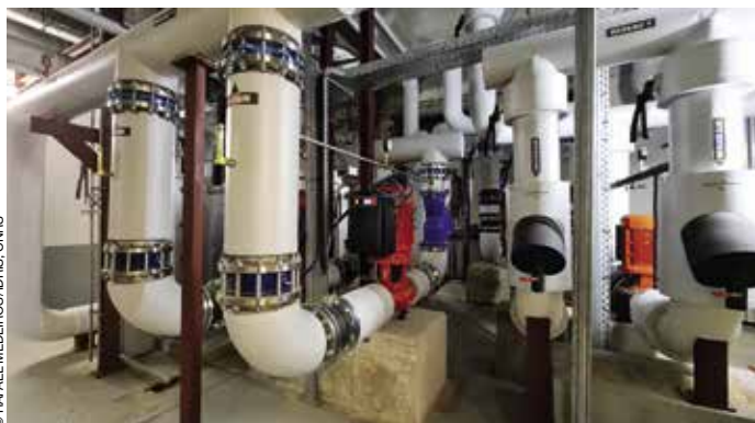
Circuit de refroidissement du supercalculateur Jean Zay (Idris/CNRS) avant son raccordement au réseau de chaleur de Paris-Saclay.
