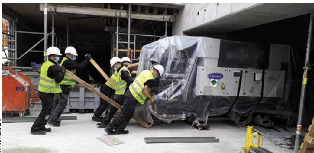
Arrivée d'une des thermo-frigopompes qui compléteront la chaleur ou le froid géothermique du réseau de l'écoquartier Issy-Cœur-de-ville (Hauts-de-Seine) en 2022.
