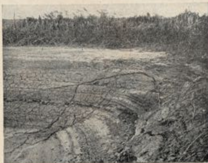
Fig. 6. — Glissement des talus dans le Klei ; la surface est séchée et crevassée.
