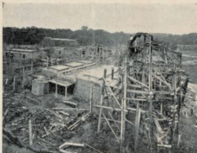
Fig. 3. — Ensemble du bâtiment en cours de construction. On remarquera d'une part la charpente extérieure destinée à maintenir les parois du rocher et, d'autre part, l'abri constitué par le couloir central et les loges des animaux.
