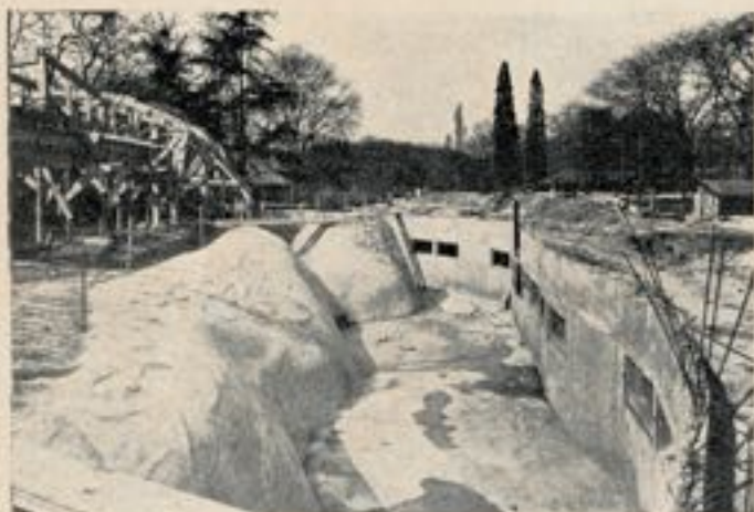
Fig 8. — Le bassin des animaux marins. Le bassin est compris entre la plage d'accès à l'abri en construction et le couloir souterrain destiné au public.
