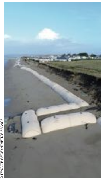
Le sable s'accumule derrière le géotube.
