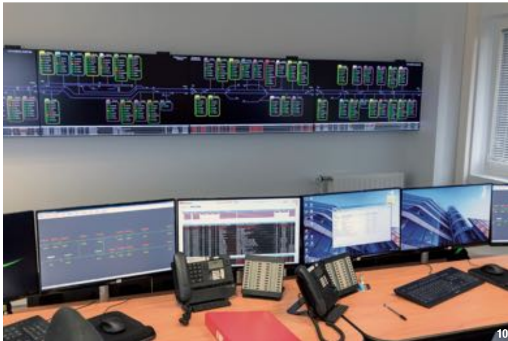
10- COBPL - centre de supervision de la maintenance de la LGV BPL.
