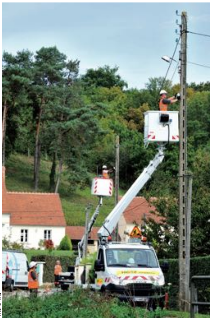
Le numérique contribue aux bonnes performances des travaux publics. Installation d'un réseau par Axione.
