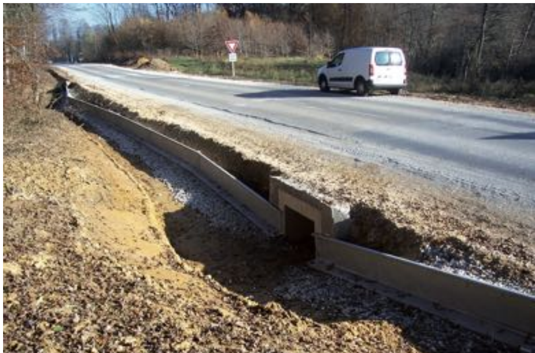
Dans le Doubs, des glissières conduisent les batraciens vers les passages sous voirie, expérience dont s'inspire la Savoie.
