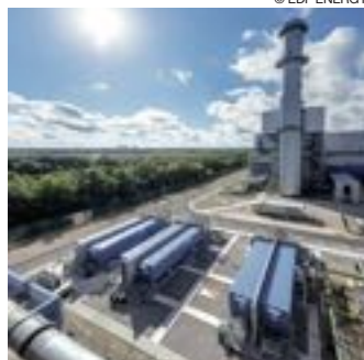
Batterie de 49 MW en 20 conteneurs à la centrale à gaz de West Burton B (Angleterre).
