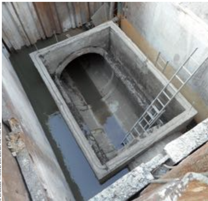
Le collecteur a été scié en deux pour entrer les tubes. Autour, la boîte en béton se refermait si besoin pendant le chantier.
