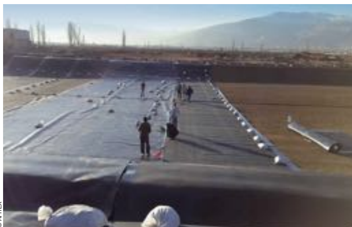
Membrane étanche pour une cellule de stockage de déchets à Zahlé (Liban).
