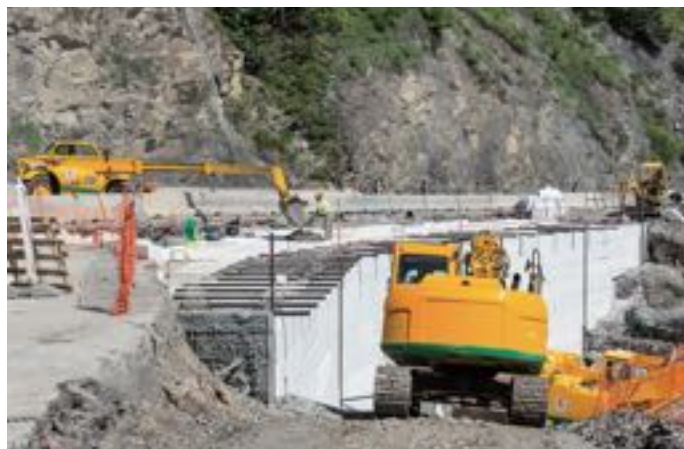
Remblai de polystyrène - blocs de 6 m de long, 1,24 m de large et 64 cm d'épaisseur - sur la RD 908 en direction de La-Foux-d'Allos (Alpes-de-Haute-Provence) posé par l'agence Cozzi de Colas Midi-Méditerranée en 2016.
