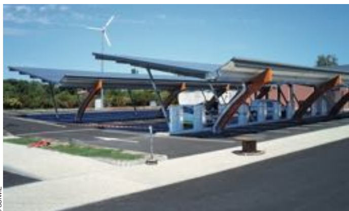
Ombrières de parking (Toulouse, 2013) avec bornes de recharge, éolienne et stockage, de Sunvie, participante au 2 e appel à projets photovoltaïques pour une centrale solaire au sol dans l'Aveyron (3,8 MWh, GDSOL Energie Pessens).
