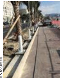
La protection en cours d'installation sur 1 km à Nice : deux câbles longitudinaux sont ensuite passés à travers les poteaux.
