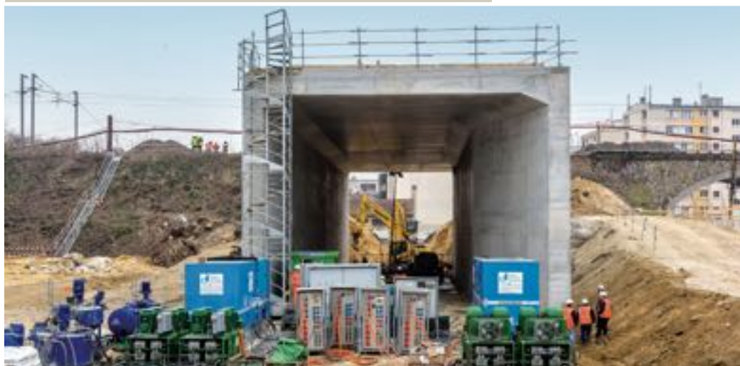
Le pont-rail avant sa mise en place dans le talus de la voie ferrée.
