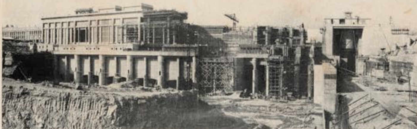
Fig. 16. — Etat d'avancement, en octobre 1951, du chantier de l'usine, du déchargeur et de l'écluse (tête aval).
