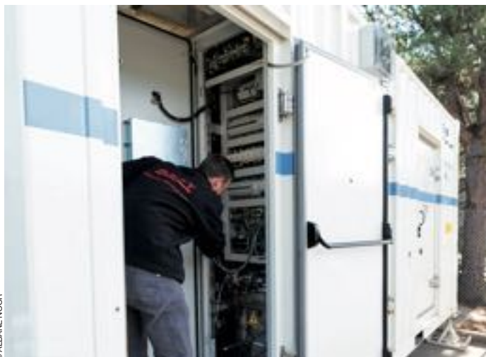
L'expérimentation du Nice Grid à Carros (Alpes-Maritimes) cherche à rapprocher consommations d'électricité et productions, traditionnelle et solaire. Le surplus, temporaire, est stocké en batterie (photo).
