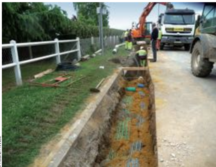
L'interconnexion court le long des routes pour faciliter son installation et les réparations.
