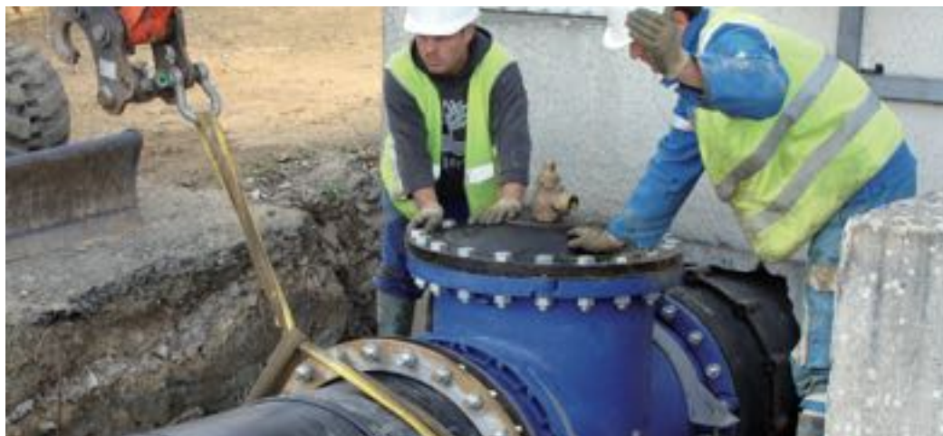
Il faudrait renouveler 3 % du linéaire des réseaux pour en stabiliser le vieillissement. Sur la photo, chantier d'eau potable à Laval (Mayenne).
