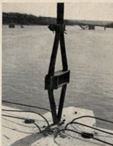
Fig. 22. — Mise en charge d'une suspente terminée (la cale métallique définitive est en place entre les deux selles).
