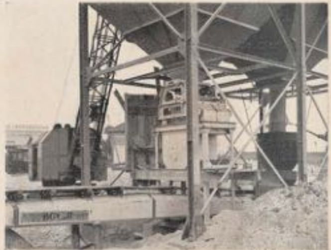
FIG. 13. — Centrale de la R. N. 10. Dispositifs de dosage et départ du tapis roulant.
