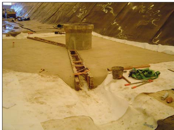
Photo 3 Puits de drainage de l'alvéole Compartment drainage shaft
