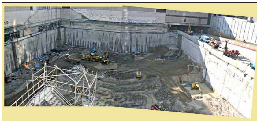
Photo 2 Vue du fond de forme en fin de terrassement View of the foundation level on completion of earthworks
