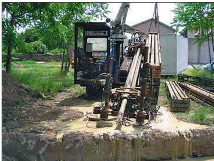
Photo 4 Traversée de l'Ouvèze par forage dirigé Crossing the Ouvèze by directional drilling
