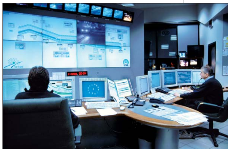
Photo 3 PC italien du tunnel du Fréjus Italian control centre for the Fréjus tunnel
