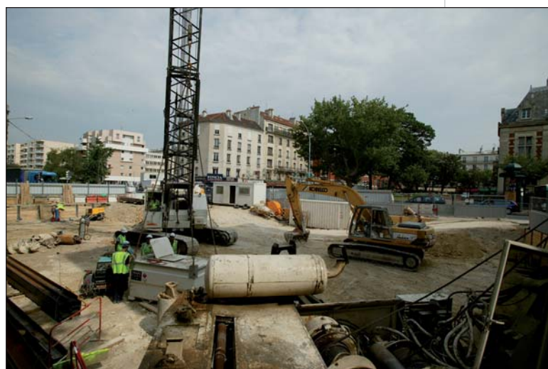
Photo 2 L'accès principal de la station, qui se situe à hauteur du Parvis de l'église Saint-Jacques, nécessite la construction d'une dalle de 660 m 2 The main access to the station, located at the level of the Saint-Jacques Church square, requires the construction of a 660 sq. m slab
