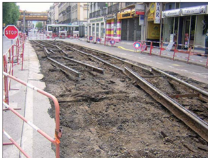
Photo 3 Voie existante en cours de démontage Sector during dismantling of the existing track
