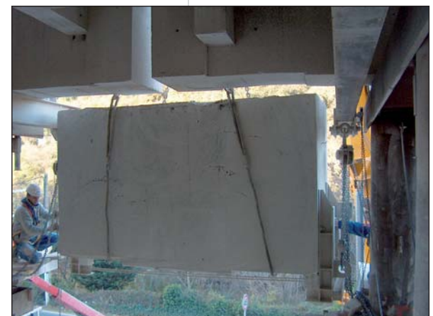
Photo 3 Ripage d'un bloc de béton armé après sciage Sliding a block of reinforced concrete after sawing
