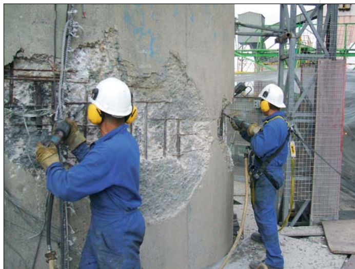
Photo 2 Purge des bétons Concrete bleeding
