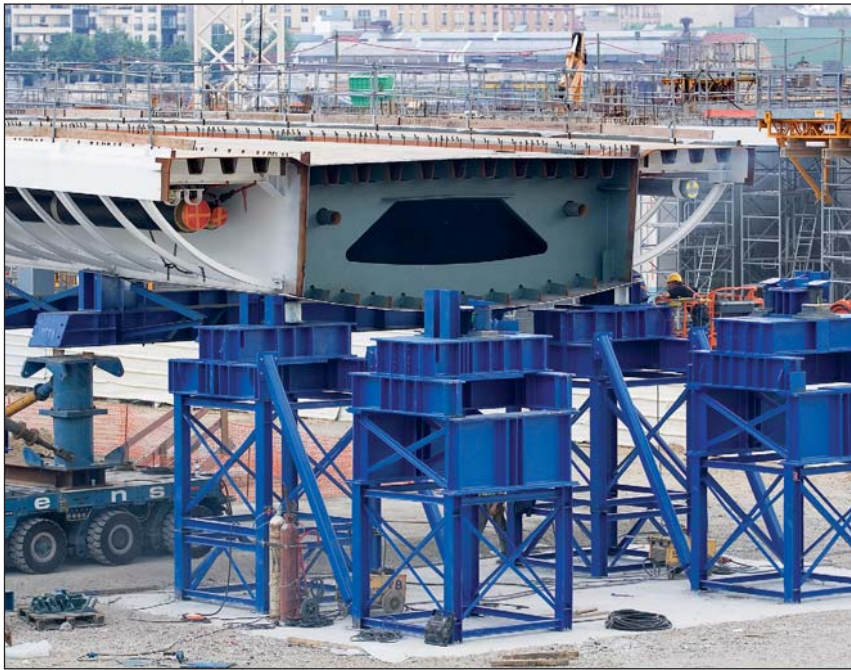
Photo 5 Réseaux embarqués sous le tablier Networks on the bridge under the deck
