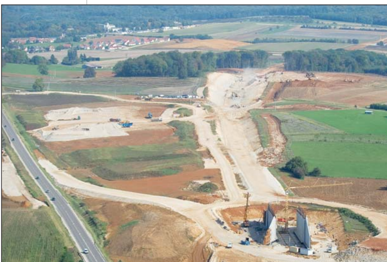
Photo 3 Pont-route 13B210 qui rétablira la RN57 sur la droite et D94 en arrière-plan Road bridge 13B210 on national highway RN57 on the right, and D94 in the background
