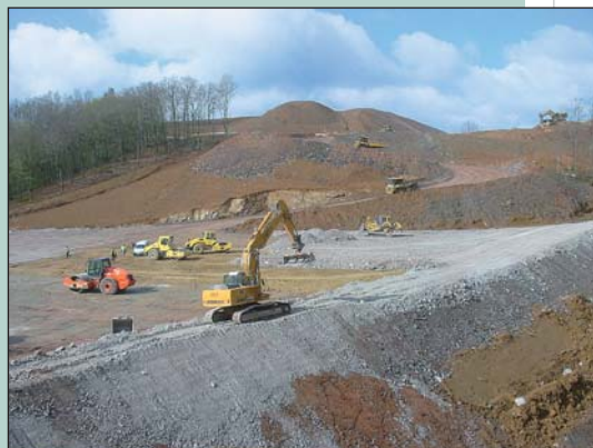
Photo 10 Parement en matériaux charpentés sur le remblai de Serre Bru Cladding with timber materials on the Serre Bru embankment
