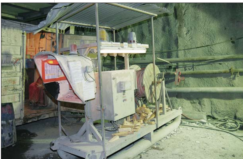
Photo 1 Système de détection de gaz à front System for detection of gas at the tunnel face
