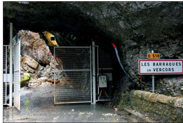
Photo 2 Éboulement sur le RD 518 aux Barraques-en-Vercors Rock slide on RD 518 at Barraques-en-Vercors
