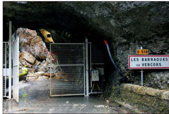
Photo 2 Éboulement sur le RD 518 aux Barraques-en-Vercors Rock slide on RD 518 at Barraques-en-Vercors
