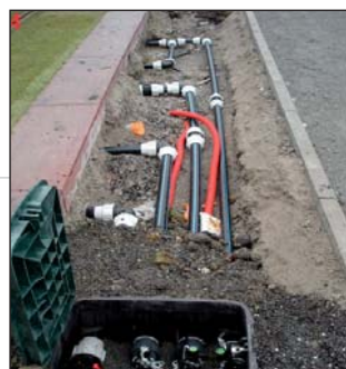
Photo 8 Alimentation en eau Water supply
