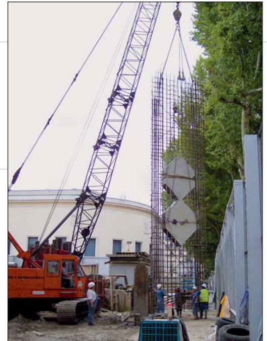
Photo 6 Réservations dans la paroi moulée pour passage du tunnelier Reserved spaces in the diaphragm wall for TBM passage
