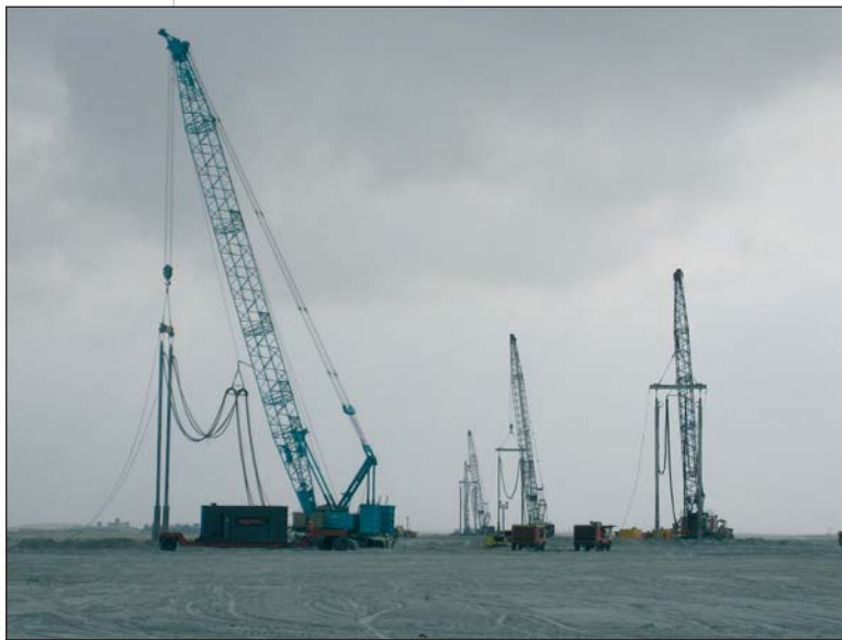
Figure 7 Les travaux se déroulent 24 heures sur 24 et 6 jours sur 7 The work is carried out round-the-clock 6 days a week
