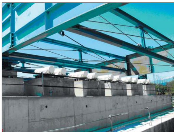
Photo 15 VIA 9.41 – Vue générale des amortisseurs VIA 9.41 – General view of shock absorbers
