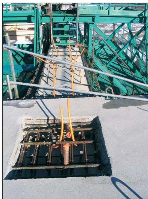
Photo 24 Le hourdis en dalles BA préfabriquées : connexion et clavage Deck section of prefabricated reinforced concrete slabs: connection and keying
