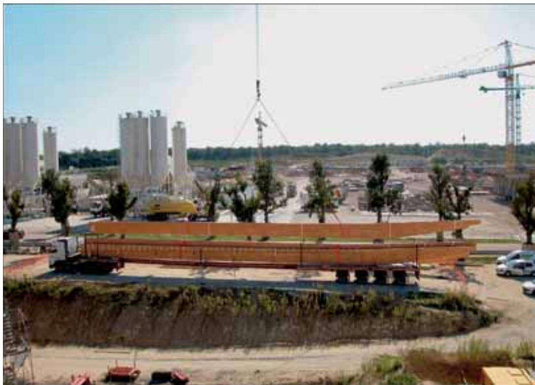
Livraison des poutres de 42 m en lamellé collé destinées au bâtiment technique
