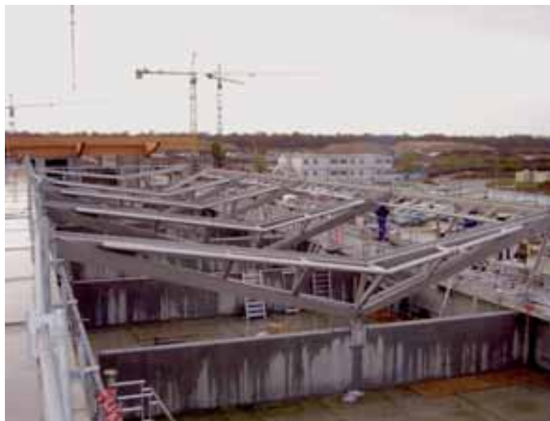
Photo 1 La couverture d'un bassin est constituée de huit poutres transversales tridimensionnelles, dont cinq courantes et trois "spéciales"
