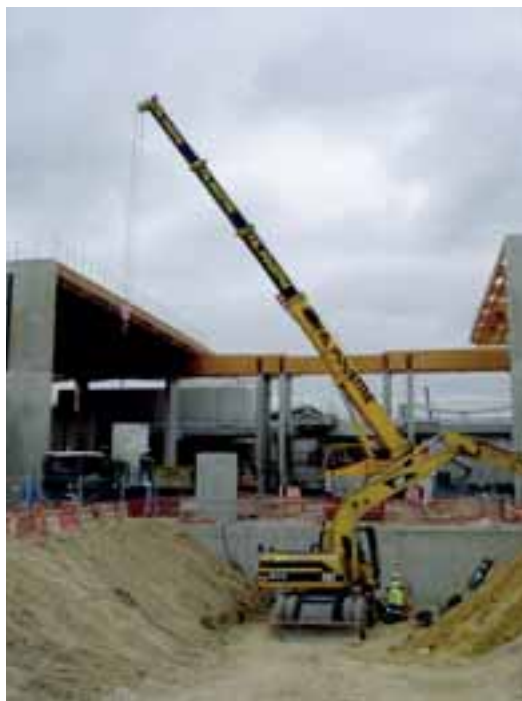
Réseau d'assainissement. Installation des puits de visite dans la zone flottateurs et illustration du voisinage rapproché des travaux des génie-civilistes, des canaliseurs et des corps d'états secondaires (charpente en lamellé-collé)
