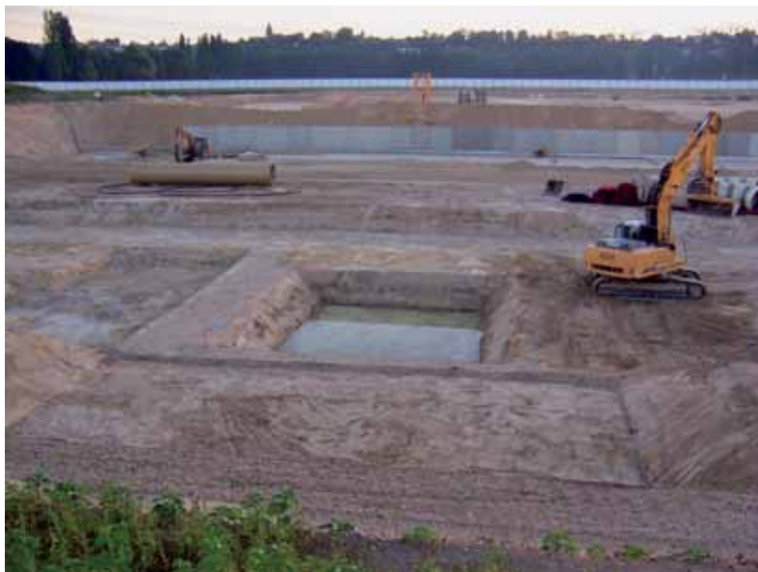
Sous le futur canal d'amenée, terrassement et réalisation du lit de pose d'un siphon. Exécutée au point le plus bas de la fouille, l'opération a imposé la mise en place d'un rabattement de nappe par pointes filtrantes
