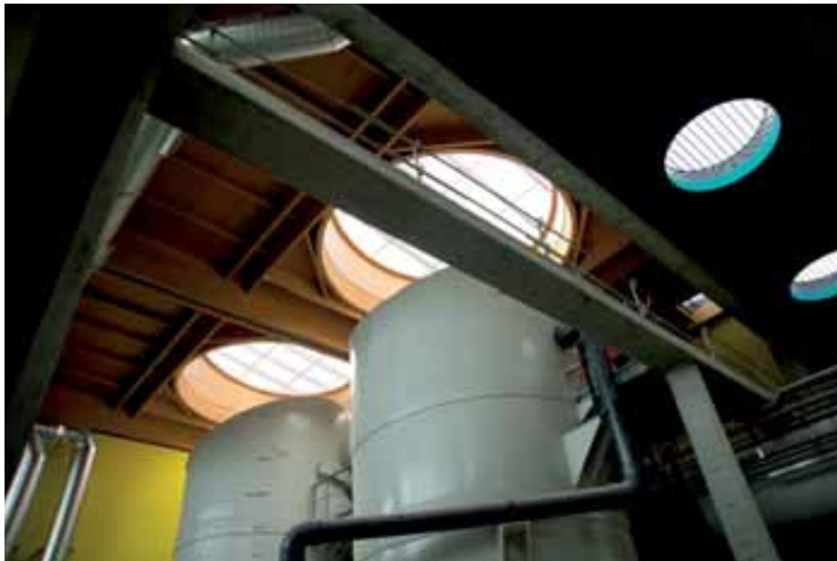
Salle de désodorisation Deodorising room
