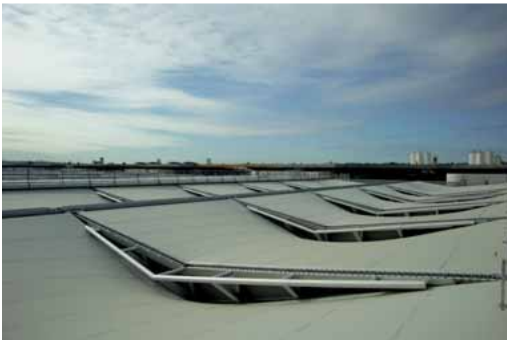
Vue générale de la couverture des bassins de biofiltres nitrifiants
