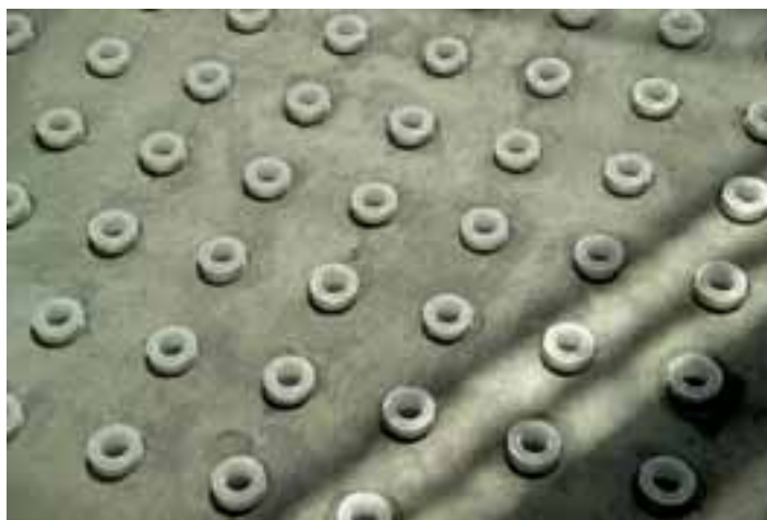
Plancher crépiné d'une cellule Biostyr® Filter-screened floor of a Biostyr® cell
