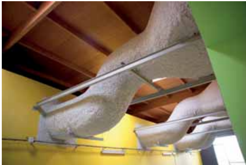
Conduits de rejet d'air des turbocompresseurs
