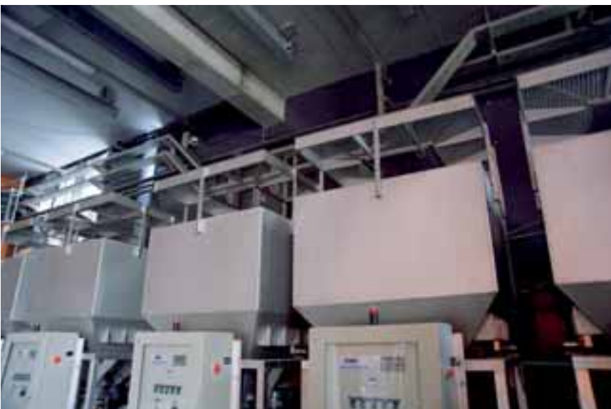
Trémies de chargement du polymère. Mise en place d'un support pour stabiliser les big-bags et sécuriser l'opérateur pendant l'opération de chargement
