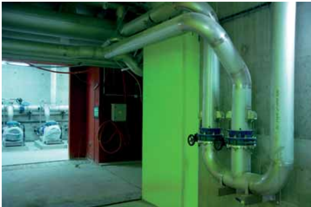
Photo 1 Positionnement de vannes de maillage d'eau industrielle à hauteur d'homme pour une accessibilité aisée Positioning of process water network valves at man height for easy accessibility
