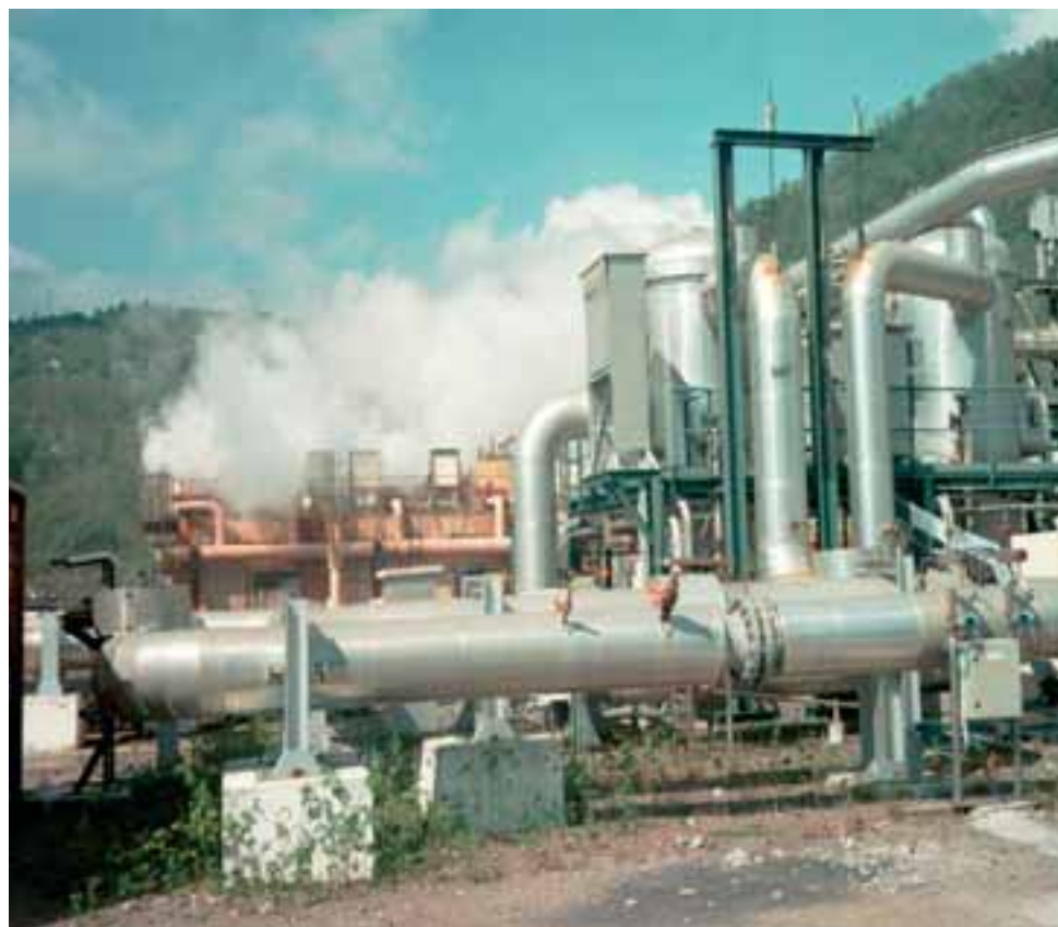
Photo 1 La centrale géothermique de Bouillante en Guadeloupe Bouillante geothermal power station in Guadeloupe
