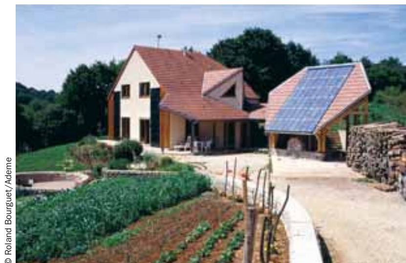
Photo 5 Des panneaux solaires photovoltaïques installés en toiture procurent à ce chalet une autonomie électrique. Saint-Véran, Hautes-Alpes, région Provence Alpes Côte d'Azur
