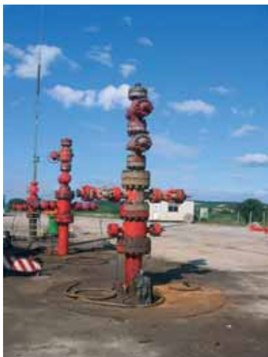
Photo 4 Les têtes de puits des trois forages de Soutz The wellheads of the three Soutz boreholes
