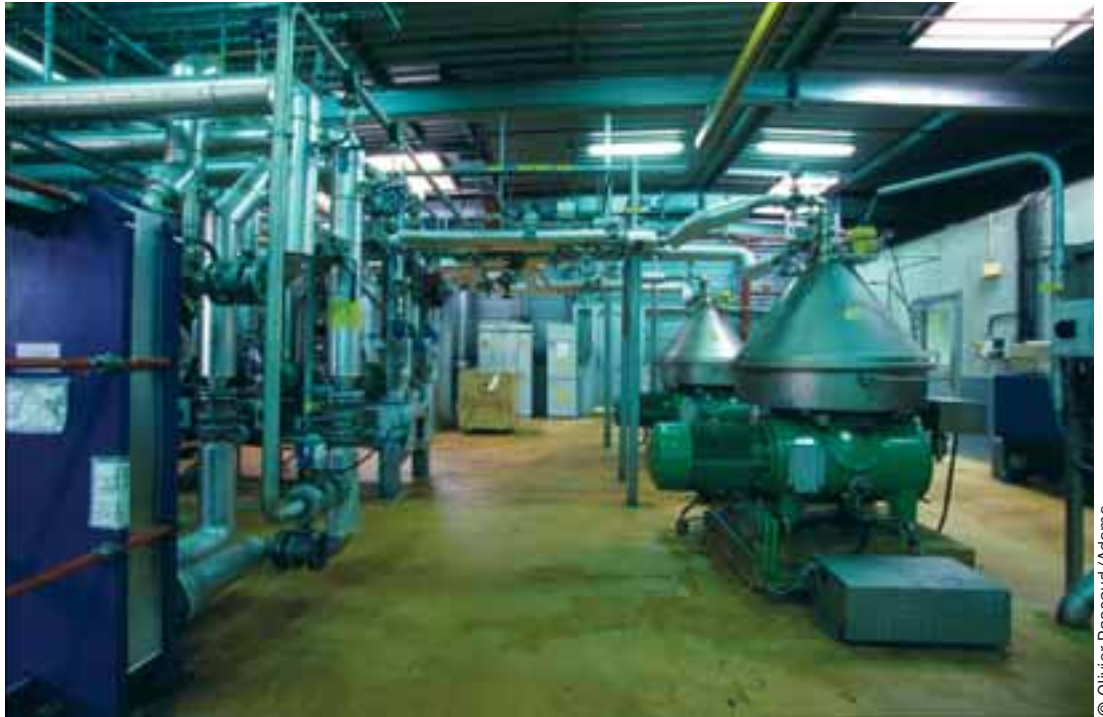
Photo 7 Fabrication de biocarburant. Centrifugeuses pour la neutralisation de l'huile brute, et pour le lavage. Diester Industrie, Groupe Prolea. Seine-Maritime Biofuel production. Centrifuges for neutralisation of crude oil and for scrubbing. Diester Industrie, Prolea Group. Seine-Maritime
