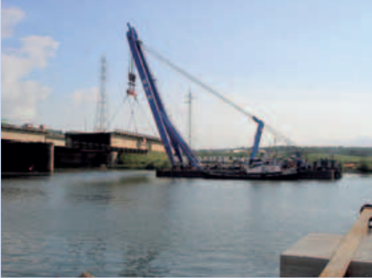
Photo 30 La bigue arrivée repliée de Hollande a été déployée avec ses caissons latéraux. La dalle orthotrope est découpée en trois tronçons. Ici levage du tronçon rive droite de 52,5 m (poids de 192 t). Chaque enlèvement prend moins de 6 heures
