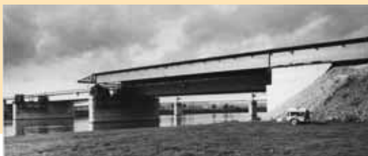
Photos 4 et 5 1966. Lancement de la dalle orthotrope du sens Metz/Thionville. L'ouvrage a été lancé au-dessus du garde-grève d'où un dévérinage général d'environ 3,7 m 1966. Launching the orthotropic slab in the Metz/Thionville direction. Note that the structure has been launched above the abutment wall, hence with general jacking down by about 3,7 m
