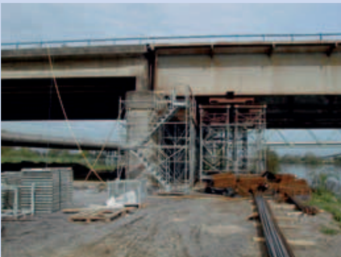
Photo 22 Accès à tous les appuis et palée provisoire nécessaire à la découpe de l'about de la dalle orthotrope pour libérer le plus tôt possible la pile-culée A
