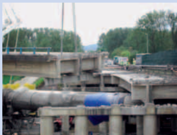
Photos 26 et 27 Grutage à l'aide de deux grues de 800 t Cranage using two 800-tonne cranes
