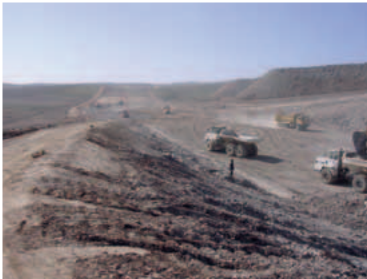
Vue générale des terrassements à l'origine des travaux General view of earthworks at the work starting point
