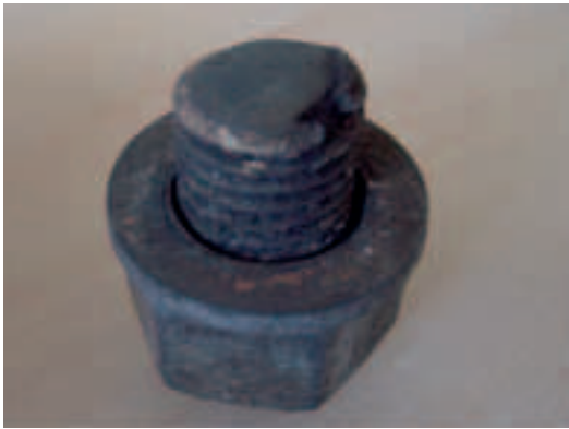
Photo 14 Exemple de boulon rompu Example of broken bolt
