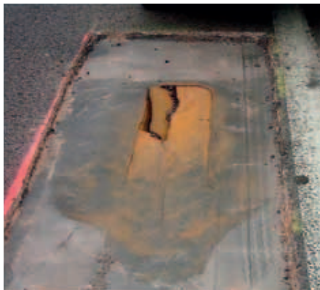
Photo 10 Photo d'une des deux zones de platelage rompu Photo of one of the two broken decking areas
