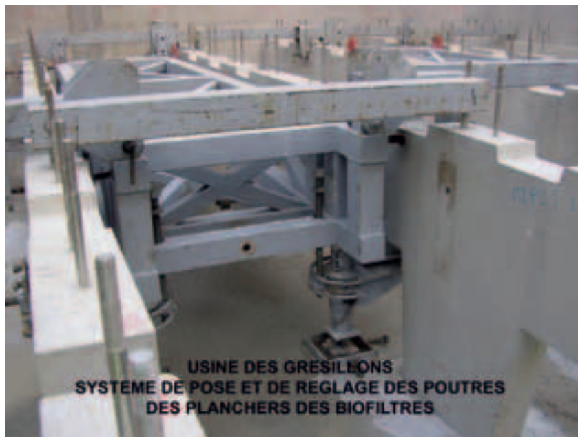
Photo 17 Système de pose et de réglage des poutres des planchers des biofiltres
