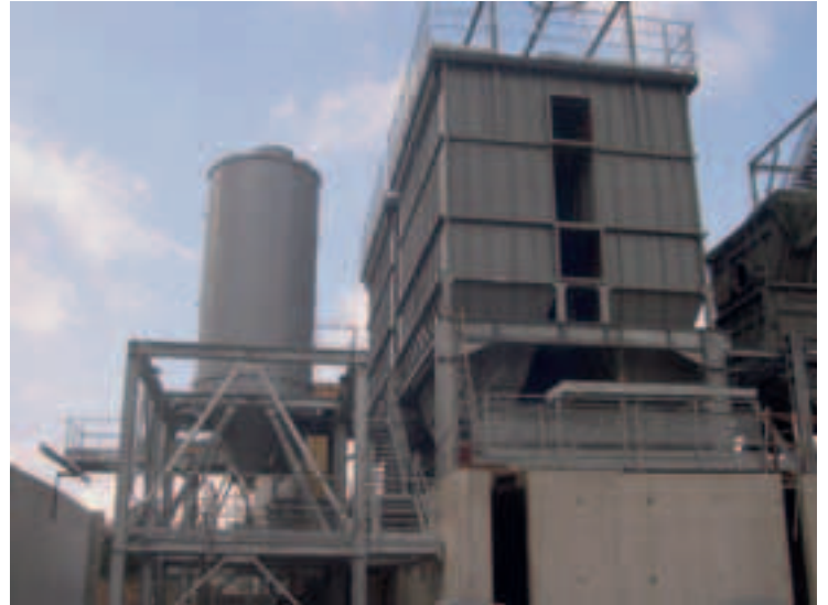
Équipements du traitement des fumées de l'usine d'incinération de Brest (Finistère) Fume treatment equipment of the Brest incineration plant (Finistère region)
