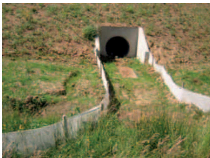
Photo 3 Batrachoduc et clôture provisoire en entonnement Frog viaduct and temporary funnelling fence
