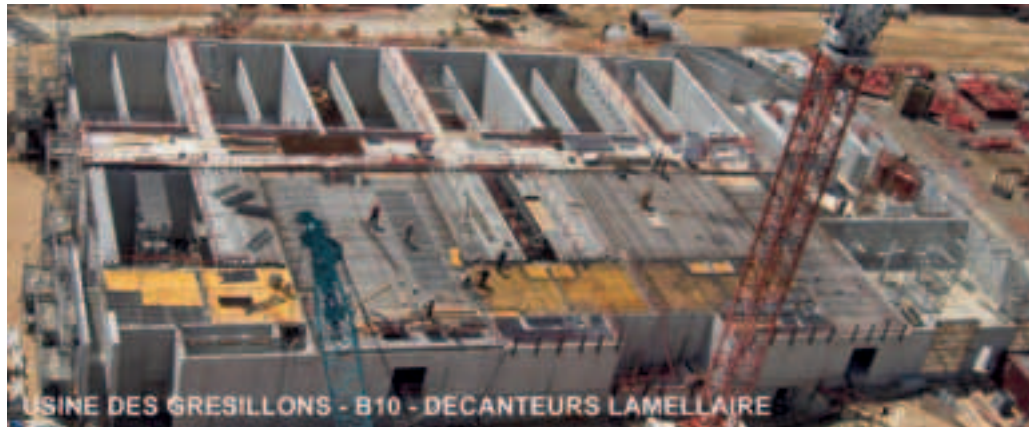
Photo 4 Décanteur lamellaire Lamellar clarifier
