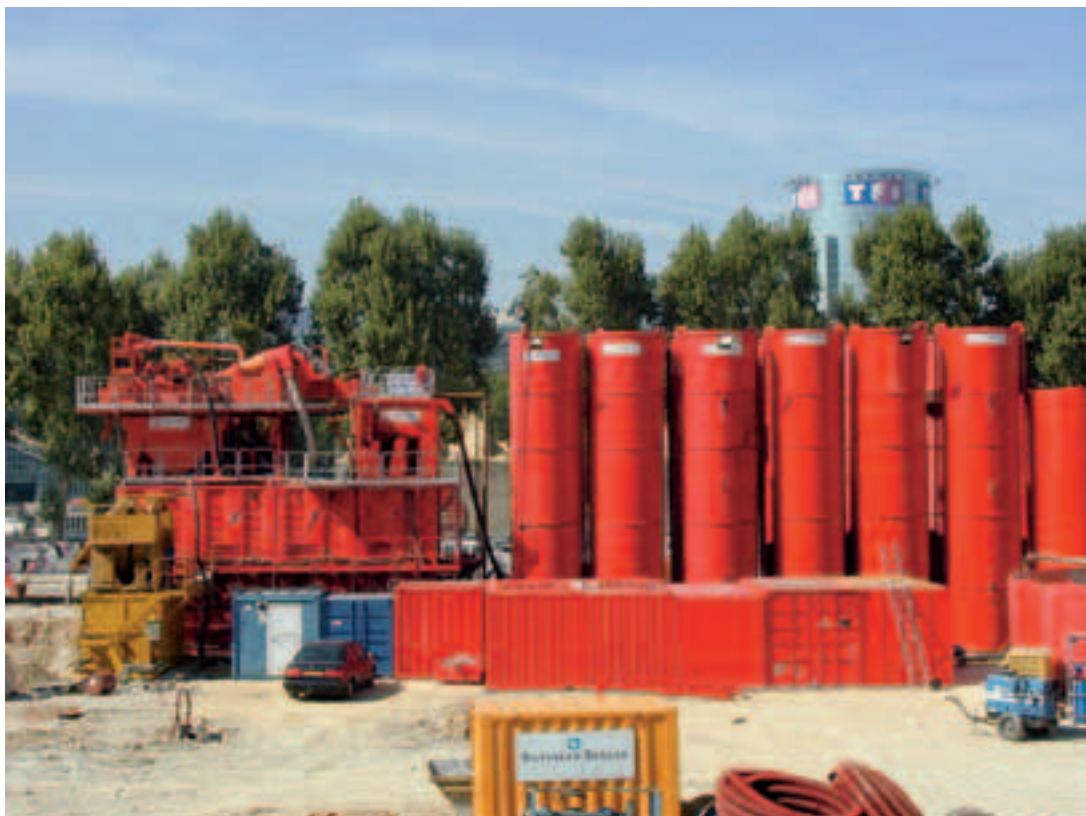
Centrale de fabrication et de traitement de la boue de forage
