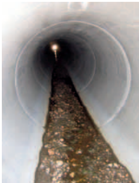
Photo 1 Intérieur d'un batrachoduc revêtu et couvert de terre
