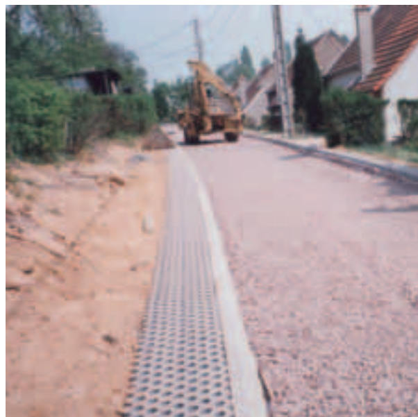
Photo 1 Creutzwald : mise en œuvre de la grave poreuse Creutzwald : application of porous gravel
