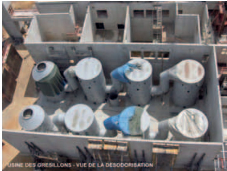
Photo 2 Vue de la désodorisation View of the deodorising facility
