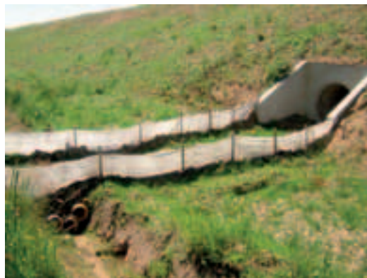
Photo 5 Batrachoduc, clôture provisoire et buse dans le fossé de pied de talus, vue latérale Frog viaduct, temporary fence and culvert in the ditch at the base of the embankment, side view
