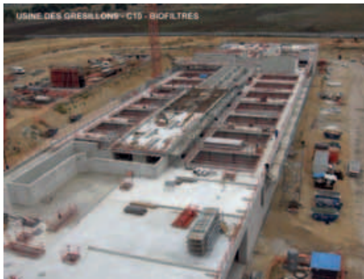
Photo 5 Ouvrage C10 : biofiltres Structure C10 : biological filters
