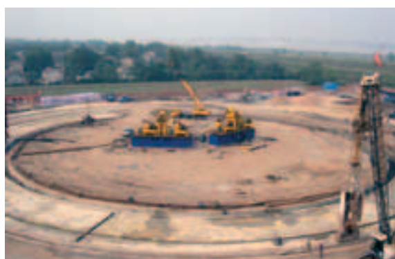
Wuhan - La plate-forme de travail pendant l'installation du chantier Wuhan - The work platform during site installation
