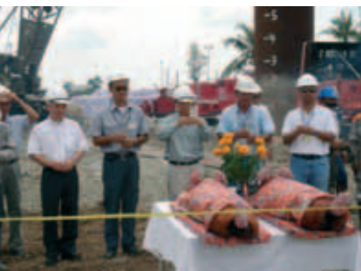
Photo 1 Le "Cung", version vietnamienne du "Ground Breaking Ceremony" pratiqué dans la civilisation chinoise, est une cérémonie propitiatoire traditionnelle de démarrage de chantier
