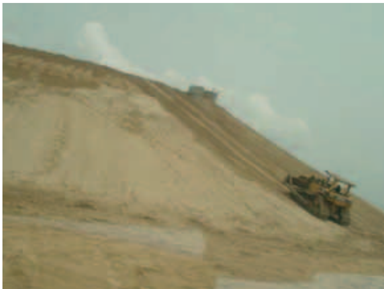
Photo 3 Opération de préchargement. Réglage du talus Preloading operation. Grading the earth bank
