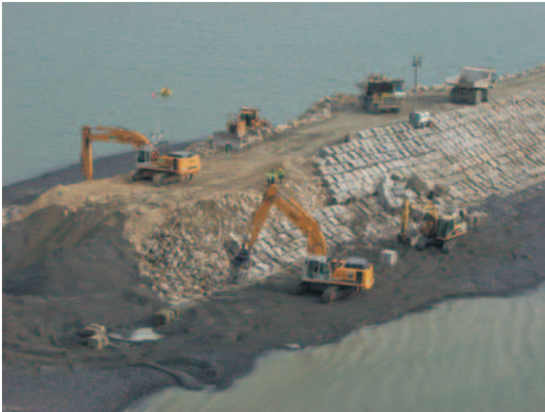
Photo 13 Construction de la digue avec des blocs Construction of the breakwater with blocks
