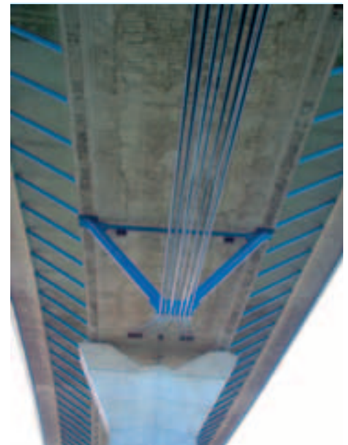
Photo 4 Mise en place des câbles du sous-bandage : vue depuis le sol Laying the sub-binding cables : view from the ground
