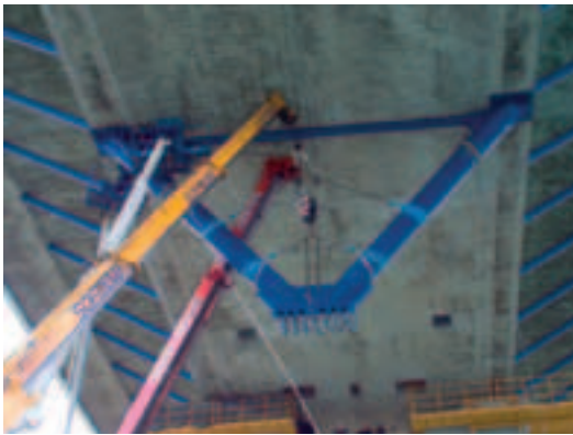
Photo 2 Mise en place d'un poinçon latéral Setting up a side truss post
