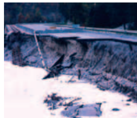
Photo 2 Dégâts causés par la crue de 1994 Damage caused by the 1994 flood
