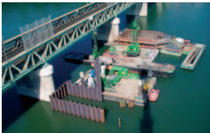
Photo 5 Opération de vibrofonçage des palplanches pour la constitution des batardeaux Operation of sheet pile driving by vibration to form the cofferdams
