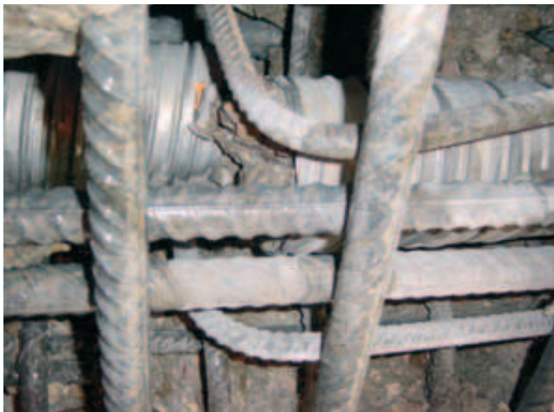
Photo 18 Gaine bouchée, vue après hydro- démolition Plugged duct, view after hydrodemolition
