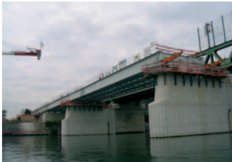
Photo 11 Phase de poussage des poutres métalliques du pont sur la Seine, à partir de la rive côté Paris Phase of pushing the steel girders of the bridge over the Seine, from the Paris side bank
