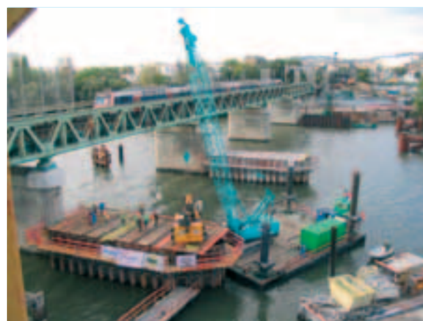
Photo 6 Forage à partir de la plate-forme installée sur batardeau Boring from the platform set up on cofferdam
