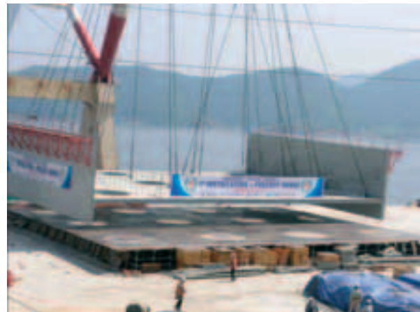
Photo 6 Levage de coque préfabriquée : phase 1, départ de la zone de préfabrication Lifting a prefabricated shell : phase 1, leaving the prefabrication area
