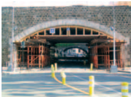
Photo 2 Paris, rue de la Poterne-des-Peupliers. Côté intrados, une passe charretière a été installée pour soutenir la voûte maçonnée pendant les travaux de renforcement
