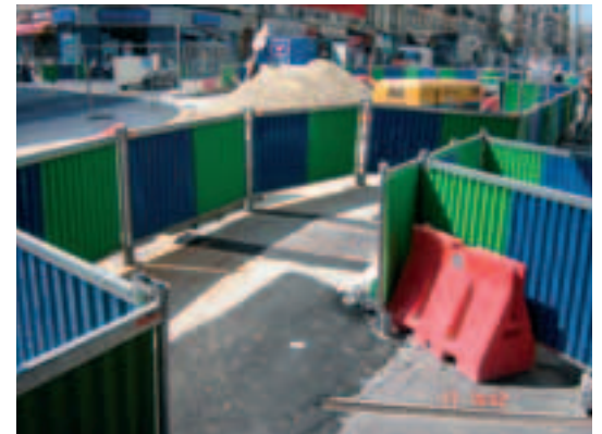
Photo 15 Nice. Pour les travaux de réfection des réseaux transversaux (lot 13), 3,5 km de clôture ont été utilisés
