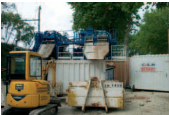
Photo 8 Le dessableur The grit chamber
