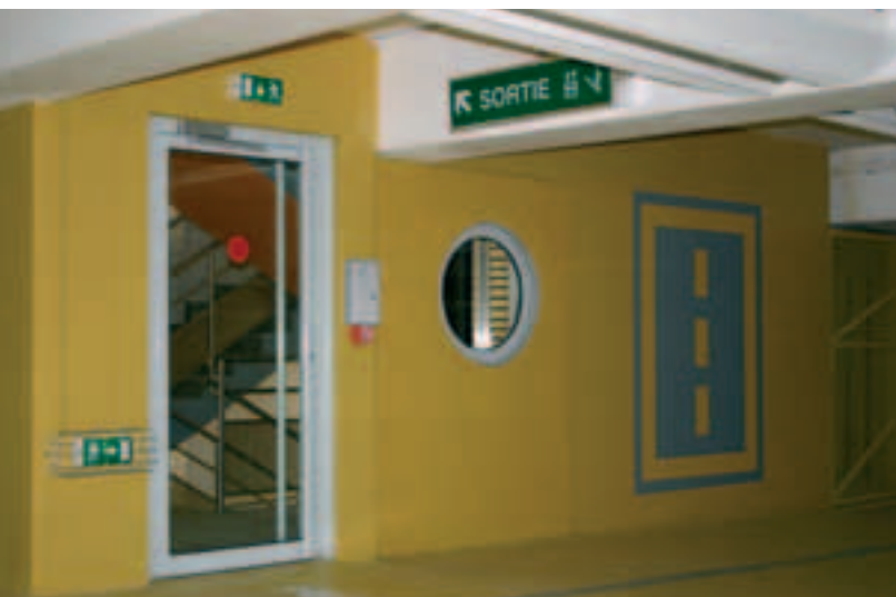
Photo 8 Cage d'escalier et d'ascenseur pour accès des piétons Stairwell and lift shaft for pedestrian access
