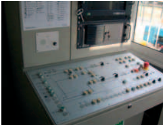
Photo 4 Poste de pilotage : le pupitre de commande Control station : the control console
