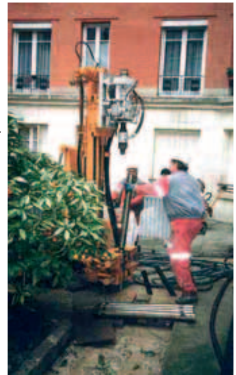
Photo 9 Foreuse à gabarit réduit pour injections rue Compans à Paris Small-size drilling machine for cement grouting in Compans street in Paris
