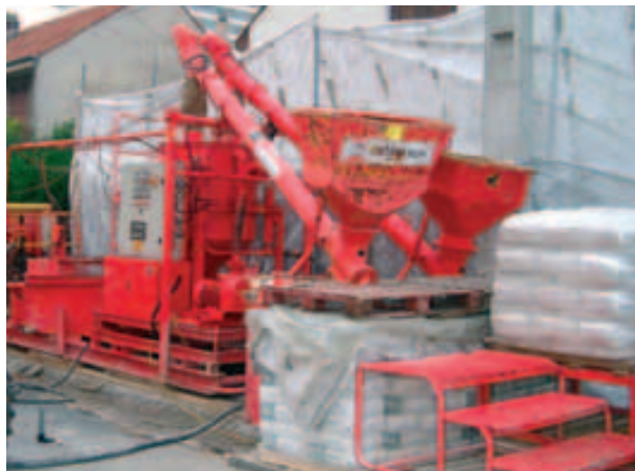
Photo 13 Centrale à mortier pour comblement de carrières à Vitry-sur-Seine Mortar mixing plant for filling quarries in Vitry-sur-Seine
