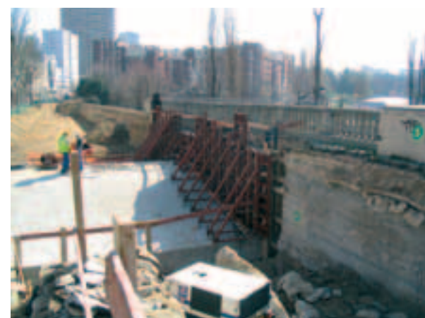
Photo 3 Paris, Poterne-des-Peupliers. La voûte ayant reçu son renfort de béton, un voile a également été coulé pour renforcer le mur tympan
