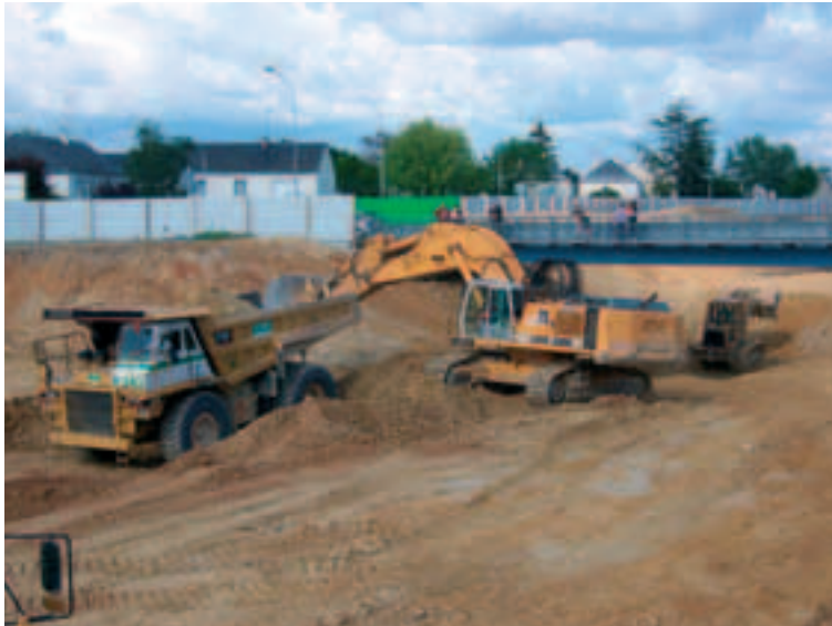
Photo 1 Terrassement de la tranchée couverte dans la zone urbaine Cut-and-cover earthworks in the urban area
