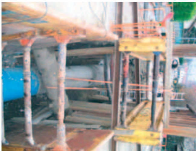
Photo 4 Grenoble. Entre les étais du blindage et les réseaux transversaux, mise en place d'un nouveau collecteur en fond de fouille
