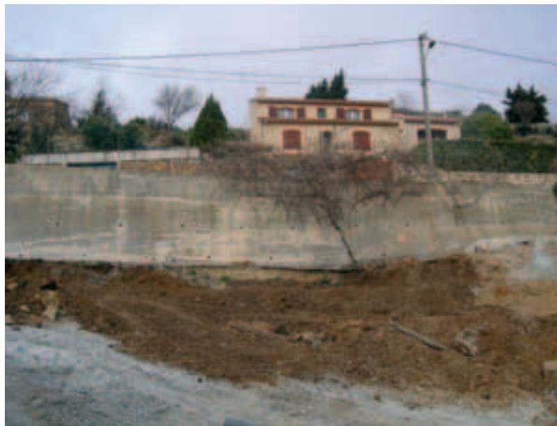
Photo 1 Pathologies sur le mur existant en béton Pathologies on the existing concrete wall
