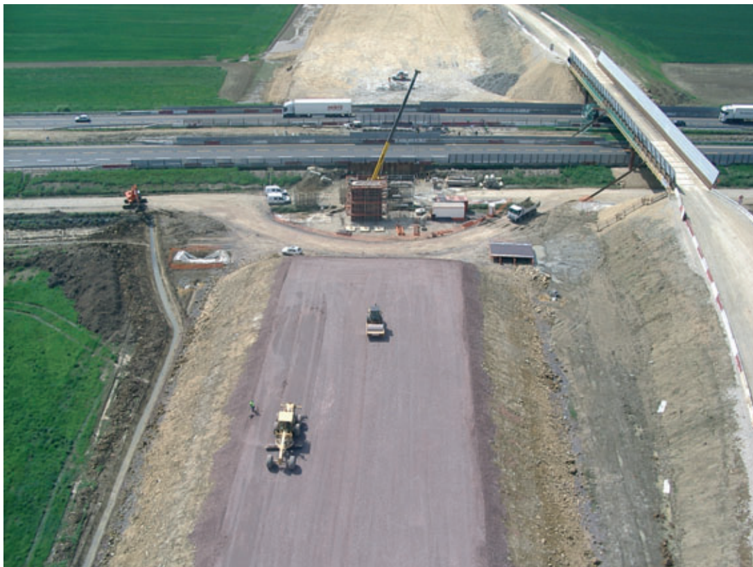
Photo 2 Ouvrage provisoire de franchissement de l'autoroute A31 et plate-forme de montage de l'ouvrage définitif
