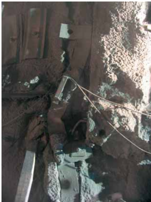
Photo 8 Déformation d'un cintre HEB 180 sous l'effet de la poussée des terrains Deformation of an HEB 180 arch due to the effect of ground pressure
