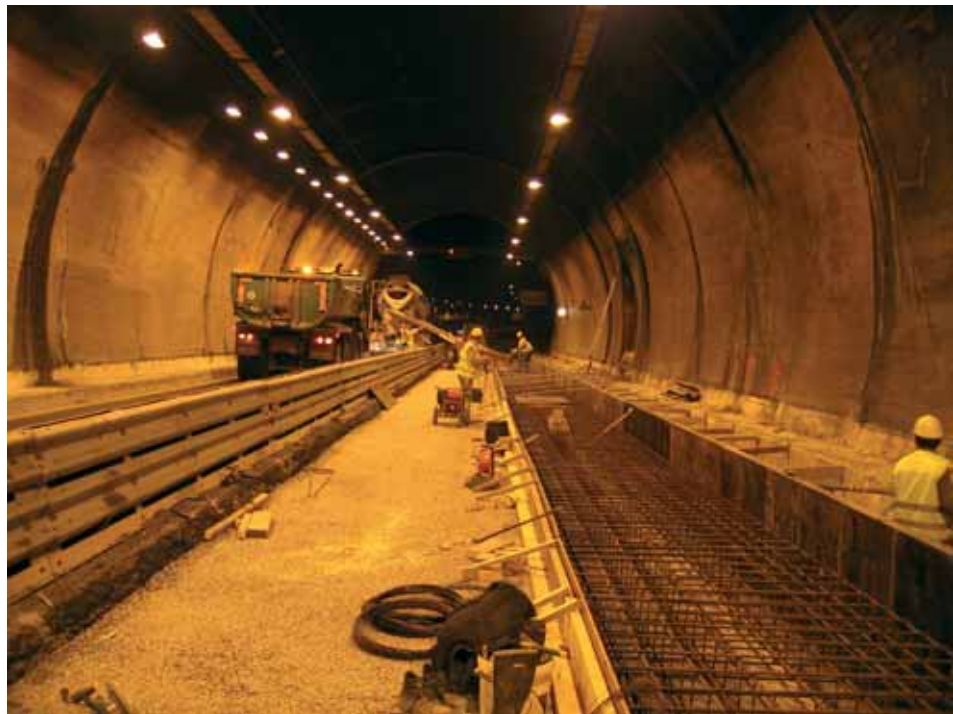
Tube nord : coffrage et ferrailage de la dalle réalisée sur le collecteur D1500 à raison de 50 m par nuit
