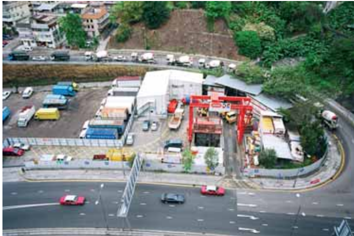
Photo 9 Installation de chantier principale au puits D de Kwai Chung Main construction plant at Kwai Chung shaft D
