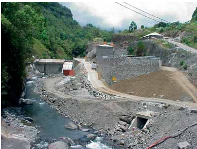
Prise d'eau de la rivière du Mât. Ensemble Water intake in the Mât river. Overall view
