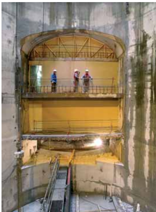
Photo 9 Dans le rameau reliant la base du puits de secours au tunnel est aménagée la niche de sécurité à deux niveaux établissant une liaison entre les deux voies de circulation
