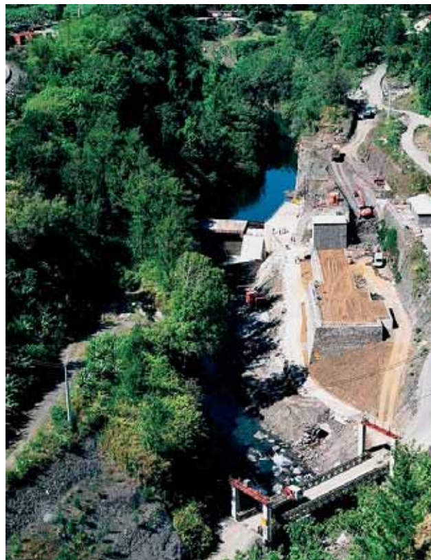
Rivière du Mât : ensemble de la prise d'eau Mât river : water intake system
