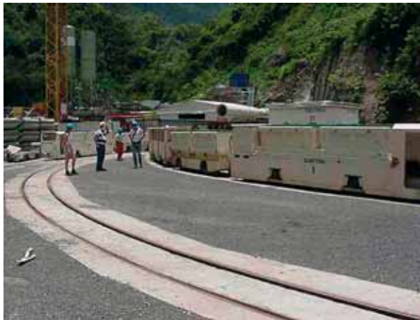
Photo 3 Galerie Salazie aval : plate-forme Sainte-Suzanne Downstream Salazie gallery : Sainte-Suzanne platform
