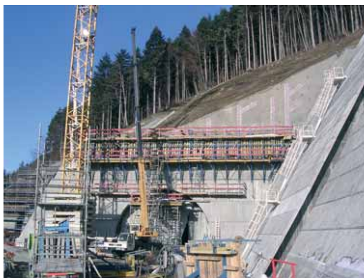
Photo 12 Tympan sud-est et mur préfabriqué incliné Southeast spandrel and inclined prefabricated wall
