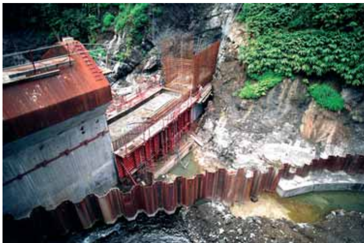
Prise d'eau de la rivière du Mât. Rideau de protection pendant la réalisation des plots 2 et 3 Water intake in the Mât river. Protective screen during the construction of blocks 2 and 3
