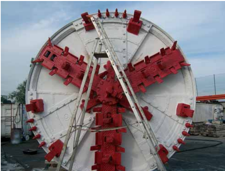
Photo 6 La tête de coupe de Jupiter, le tunnelier à pression de terre qui doit forer la galerie de liaison entre le DO Bièvre et le puits d'accès à Tima
