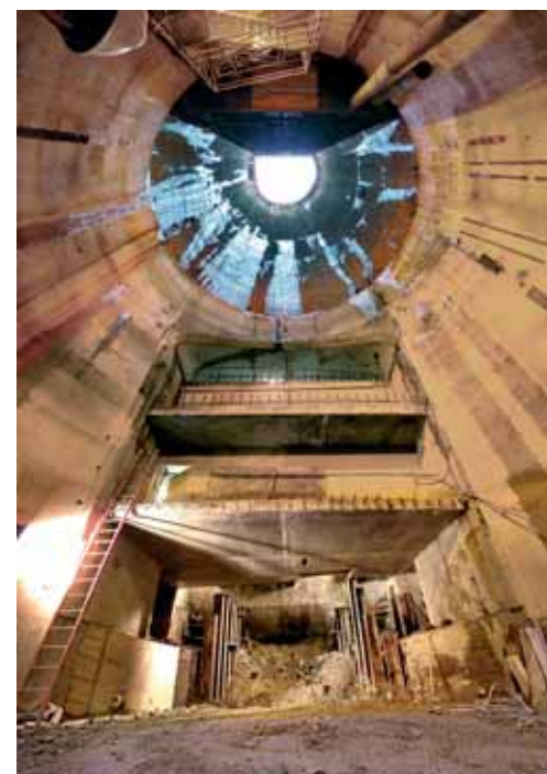
Photo 7 Profonds de 25 à 87 m et d'un diamètre courant de 7,30 m à l'exception de deux d'entre eux, les puits de secours de l'A86 Ouest sont reliés aux voies de circulation par un "rameau", ici en cours de construction, et sont équipés d'un ascenseur et d'un escalier destinés aux interventions de secours depuis la surface
