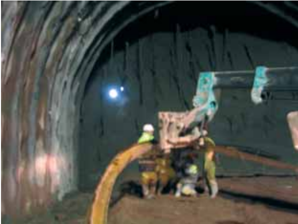
Préparation pour pose d'un cintre de soutènement Preparation for placing a supporting arch
