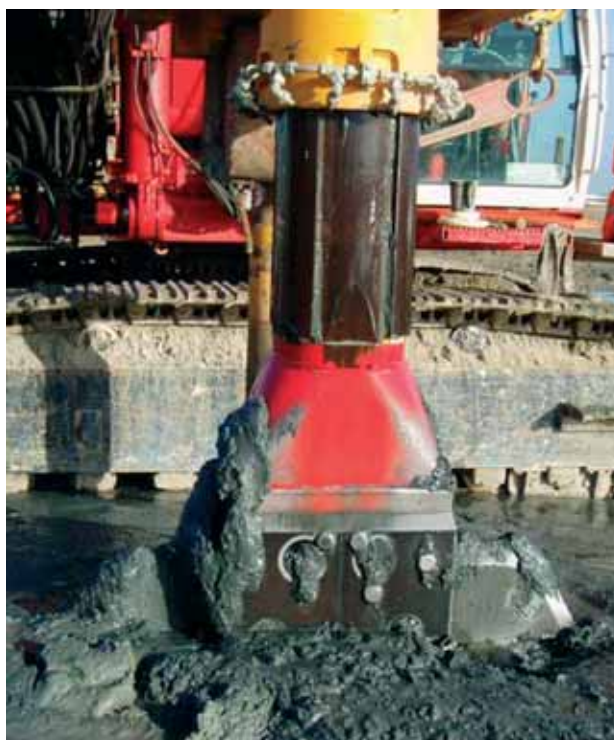
Photo 3 Fin d'exécution d'un panneau, remontée de l'outil End of construction of a panel, raising the tool again
