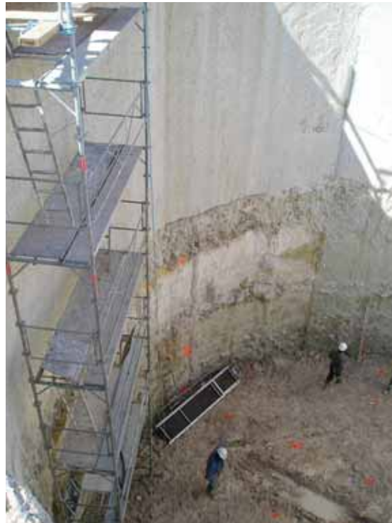
Fin du terrassement, la partie inférieure de la paroi moulée reste à raboter End of earthworks, the lower part of the diaphragm wall remains to be planed
