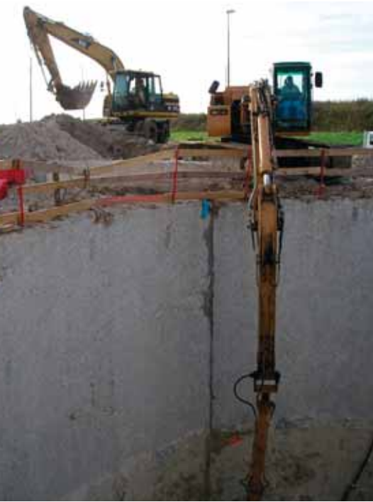
Terrassement à l'intérieur de la paroi moulée Earthworks within the diaphragm wall
