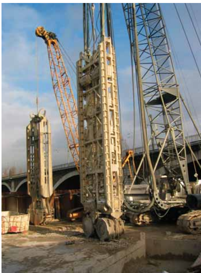
Photo 3 A gauche la benne spéciale, à droite la Rotoforeuse, au fond le Pont National On the left the special grab, on the right the Rotoforeuse rotary drill, in the background the "Pont National" bridge
