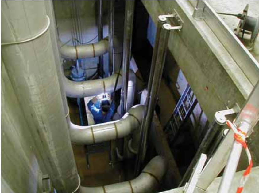
Photo 7 Les conduites de refoulement des pompes The pump discharge pipes
