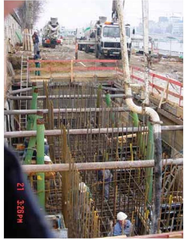
Photo 4 Ferrailage du massif "catène" en rive droite, les tubes de couleur verte sont les réservations pour les tirants
