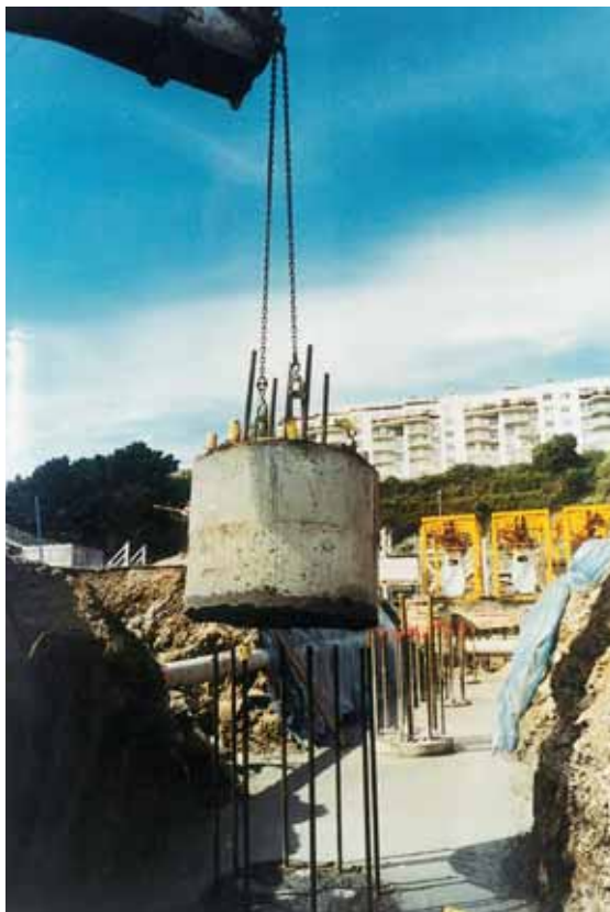
Photo 2 Tête de pieu prérecépée avec procédé Recepieux Pile head precut-off with Recepieux process
