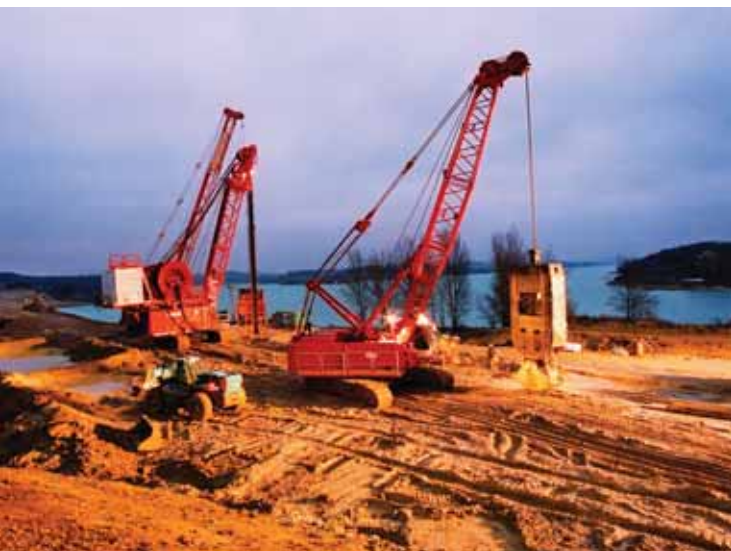
Photo 5 La benne mécanique et l'hydrofraise en poste de nuit The mechanical grab and hydro-cutter working night shift
