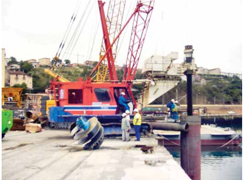
Photo 2 Réalisation des pieux depuis le quai Construction of piles from the dock
