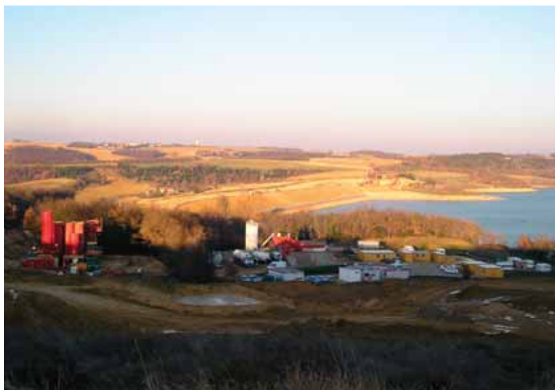
Photo 1 Vue du barrage, des installations en rive gauche et des ateliers de paroi moulée en rive droite View of the dam, the installations on the left edge and the diaphragm wall equipment on the right edge
