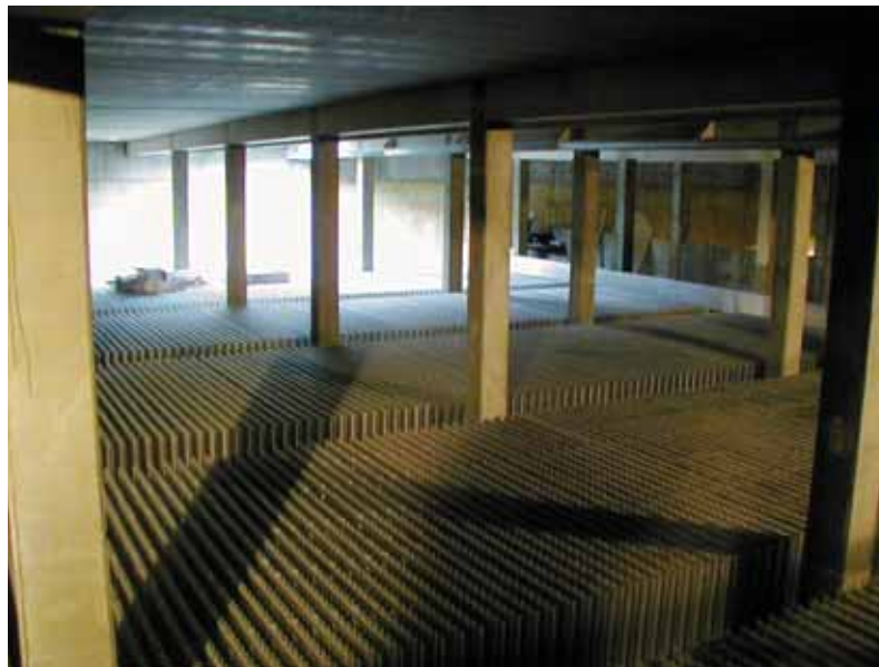
Photo 6 Le décanteur lamellaire
