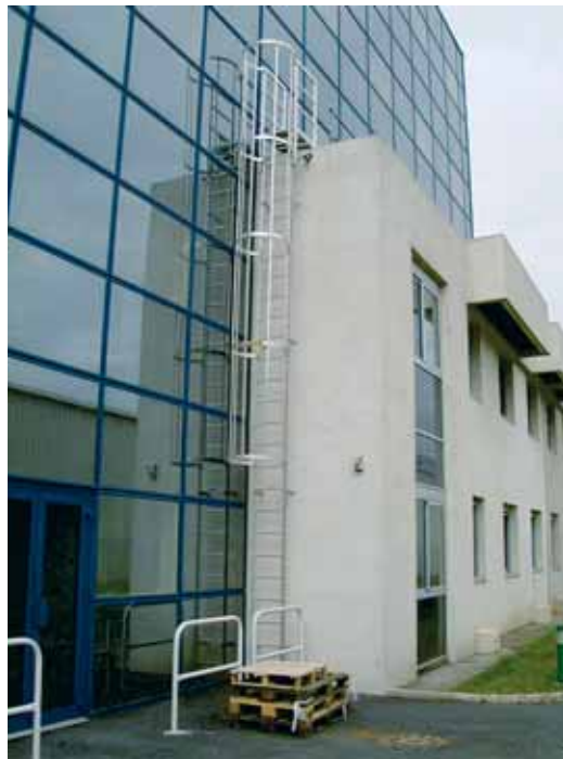
Echelle à crinoline avec palier destinée à l'évacuation du personnel (site industriel Carros)
