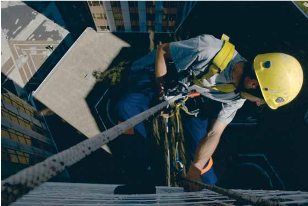
Prise de mesures par un technicien Apic Measurements taken by an Apic technician
