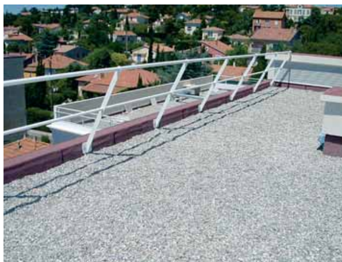
Garde-corps fixe laqué blanc et incliné pour une meilleure intégration sur la toiture terrasse d'une copropriété de standing à Saint-Raphaël
