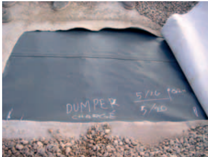
Photo 7 Examen de la géomembrane après circulation du tombereau chargé support 5/20 protection 20 cm de 5/16
