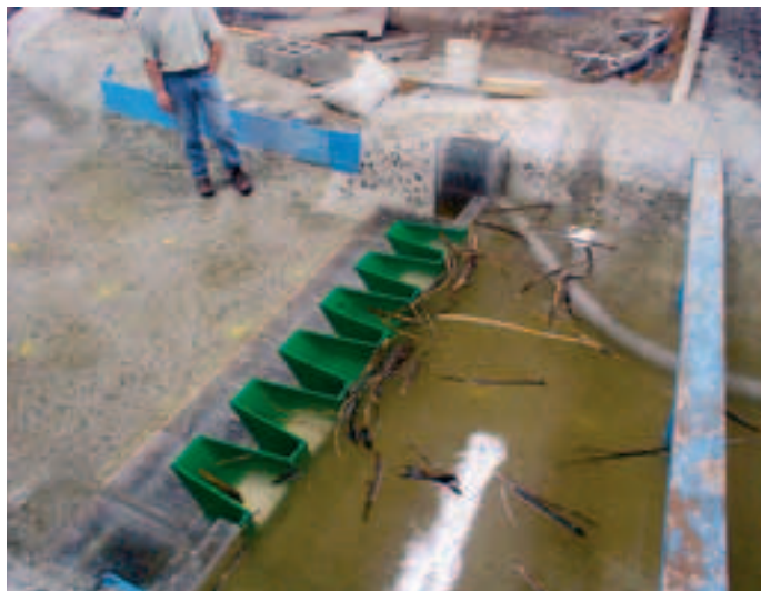
Photo 3 Impact de corps flottants sur les hausses fusibles Impact of floating bodies on the fuse gates
