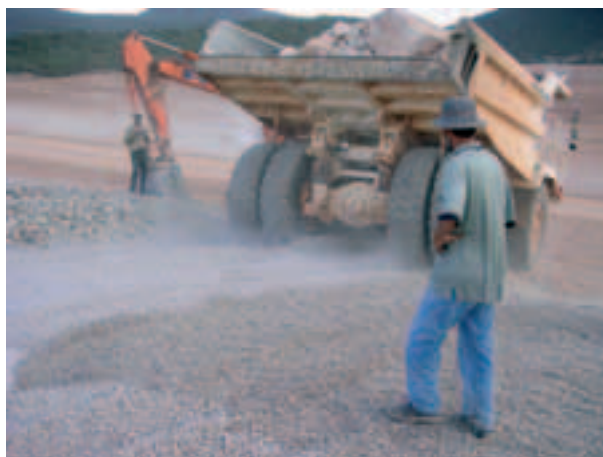
Photo 4 Première planche d'essais; passage du tombereau (50 t sur 20 cm de gravier 5/20 au-dessus du complexe d'étanchéité, talus à 5/1)
