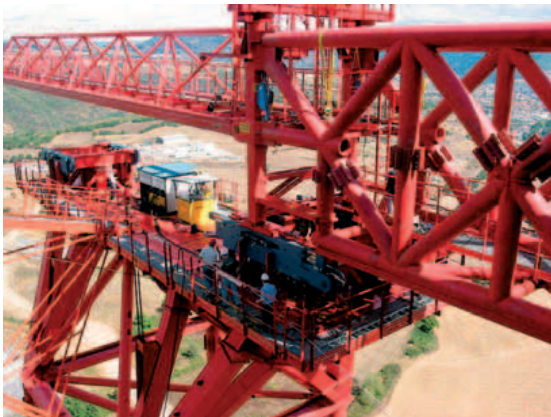
Photo 6 Ensemble de quatre translateurs et balancelles avec groupes hydrauliques installés sur une pile temporaire Set of four side shifters and rockers with hydraulic systems installed on a temporary pier
