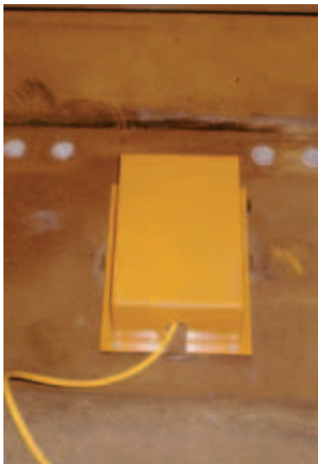
Vue d'un accéléromètre en fond de caisson central View of an accelerometer at the end of the central box section
