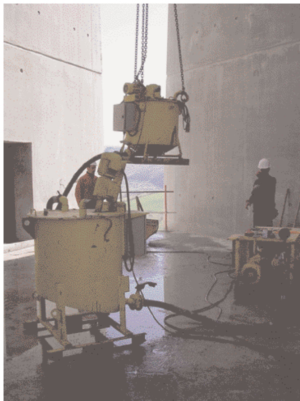
Photo 4 Centrale d'injection de coulis de ciment Cement grouting plant
