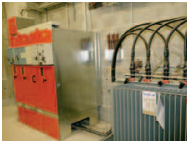
Photo 1 Poste de livraison/ transformation 20 kV du viaduc
