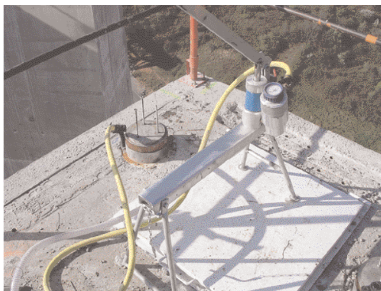
Photo 3 Pompe manuelle de réinjection des têtes de câbles
