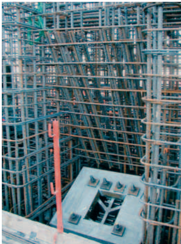
Photo 1 Appui d'un chevêtre provisoire de pile Support for a temporary pier header
