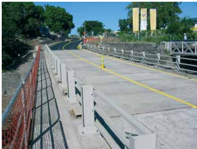
Photo 5 Pont mis en place à l'aide d'éléments en béton armé préfabriqués Bridge set up using prefabricated reinforced concrete elements
