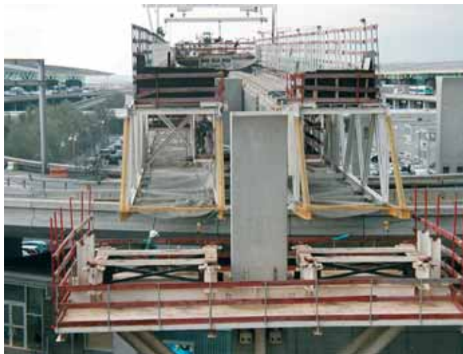
Photo 4 L'avancement du cintre : accostage d'une pile Moving the centre forward : berthing against a pier
