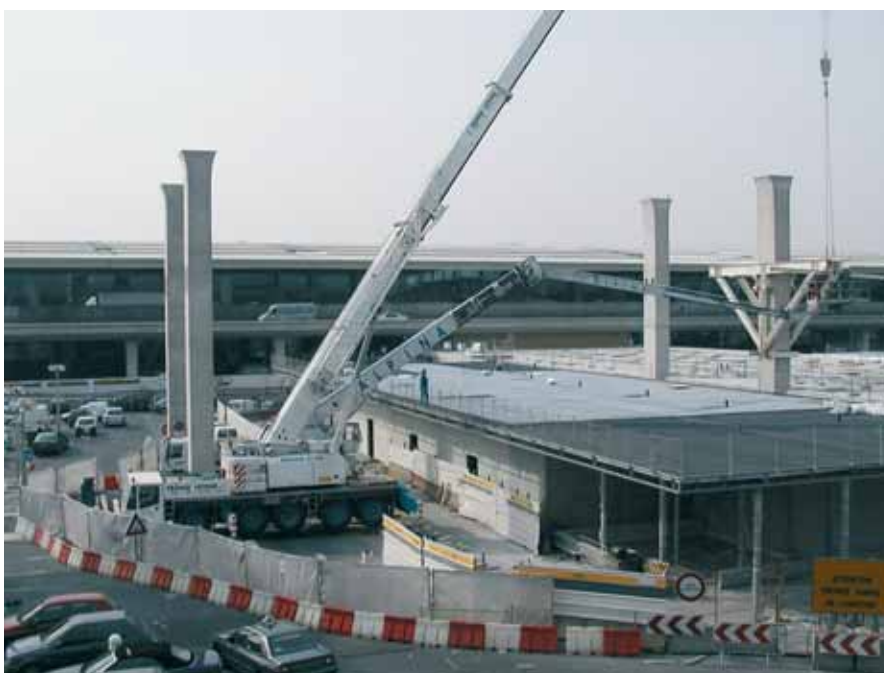
Photo 6 Pose des consoles sur la pile P19, au-dessus de la galerie de liaison
