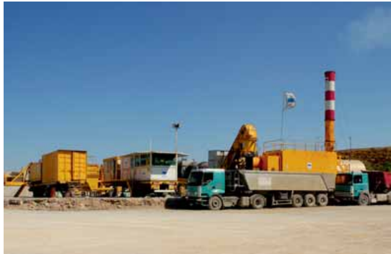
Photos 3 et 4 Aire de fabrication - Centrales mobiles de fabrication : TSM 25 Major et TSM 17
