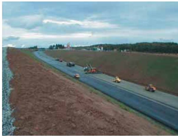
Déblais près de Letkov et centrales d'enrobage mobile et stationnaire - Mise en place de l'enrobé Earth cuts near Letkov and mobile and stationary mixing plants - Laying asphalt
