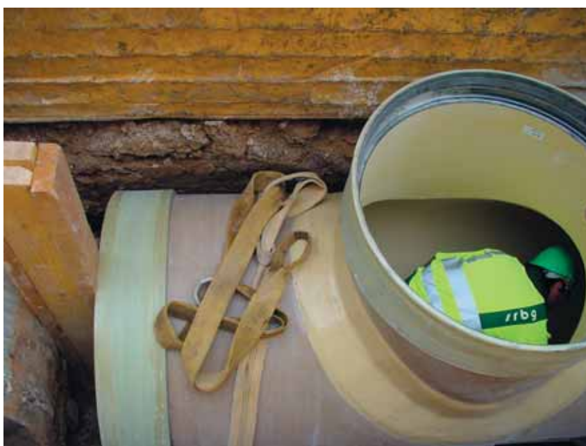
Photo 4 La canalisation PRV de Hobas
