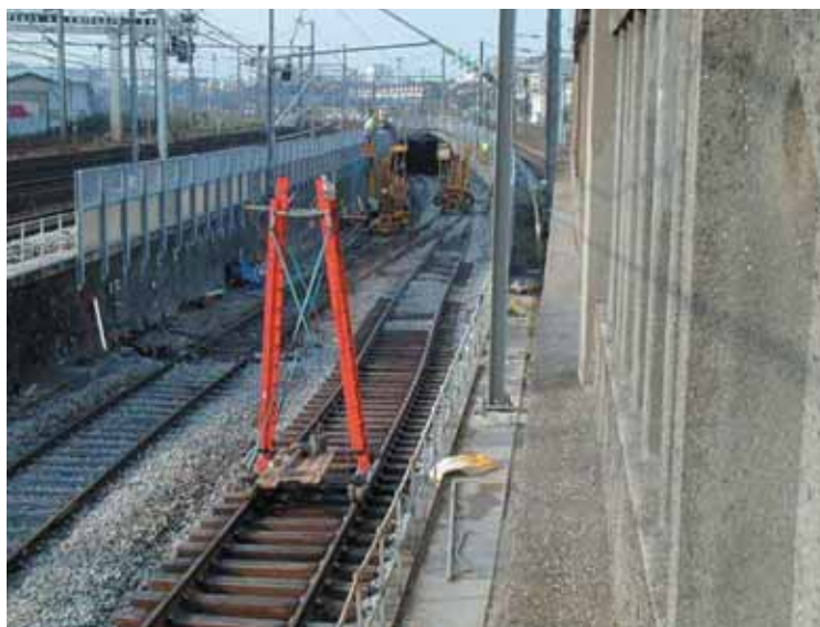
Photo 2 Le 8 septembre 2003, le souterrain a été mis en service à deux voies On 8 September 2003, the tunnel was put into operation on two tracks
