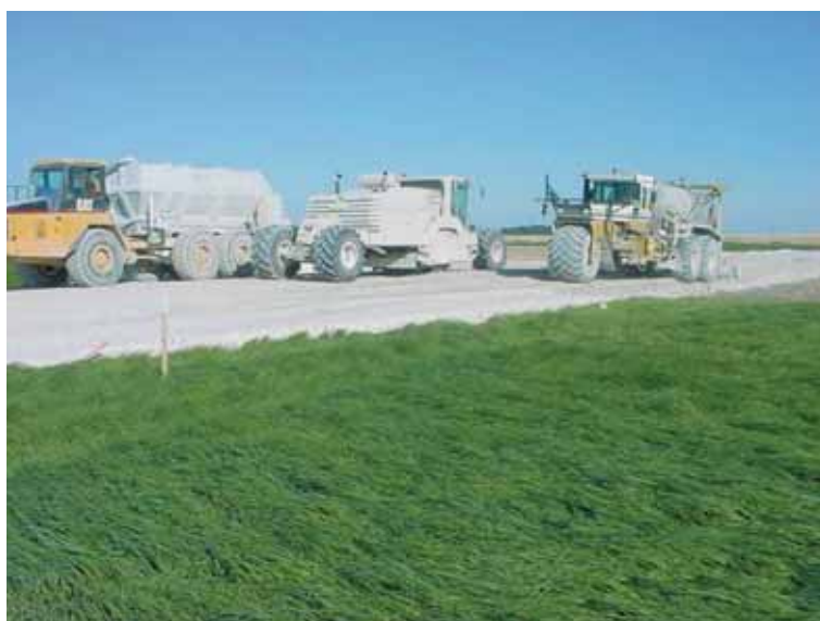
Photo 4 Atelier de traitement Treatment plant
