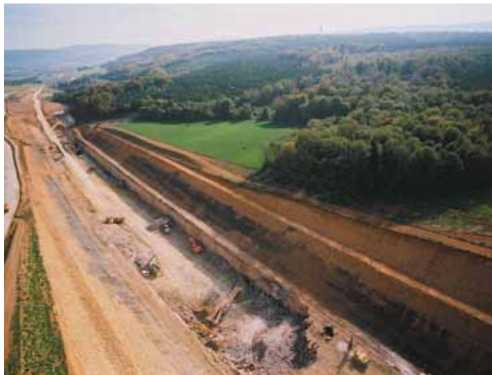
Photo 9 Extraction des calcaires du déblai de Prény Extraction of limestones from the Prény earth cut
