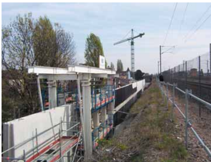
Photo 3 Outil coffrant créé par Maia Sonnier pour construire le mur de soutènement le long du talus
