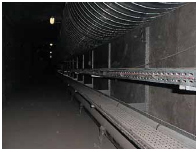
Photo 2 Chemin de câbles en galerie technique Cable tray in main services duct
