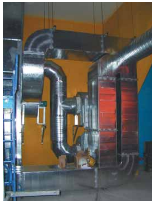
Ventilateurs des ouvrages de sécurité Safety structure fans
