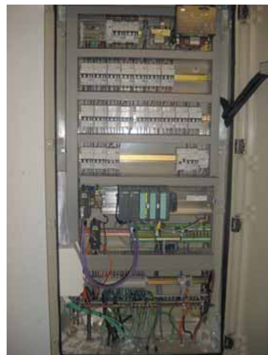
Photo 3 Coffret d'alimentation en tunnel avec interface GTC Power supply unit in tunnel with BMS interfacing
