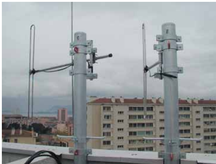
Antennes hertziennes Microwave antennas
