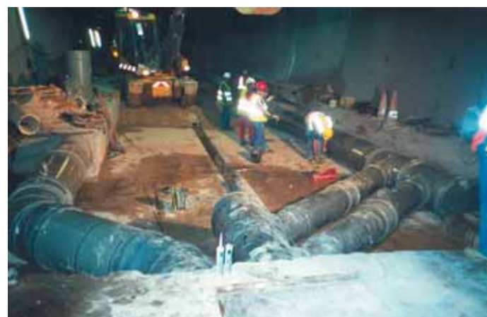
Réseau de ventilation des ouvrages de sécurité
