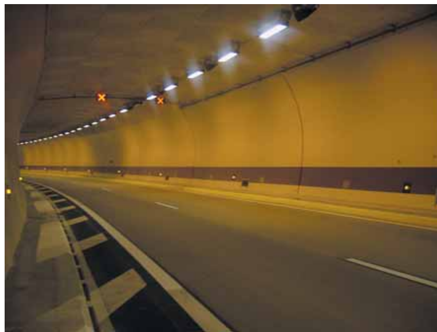
Eclairage architectural des piédroits dans les virages
