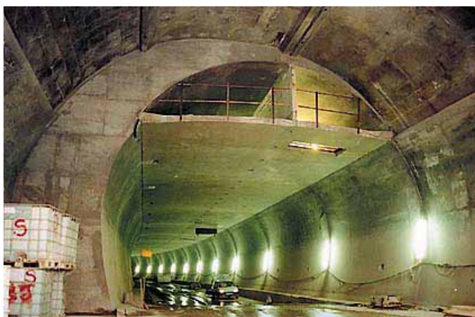
Les gaines de ventilation Ventilation ducts
