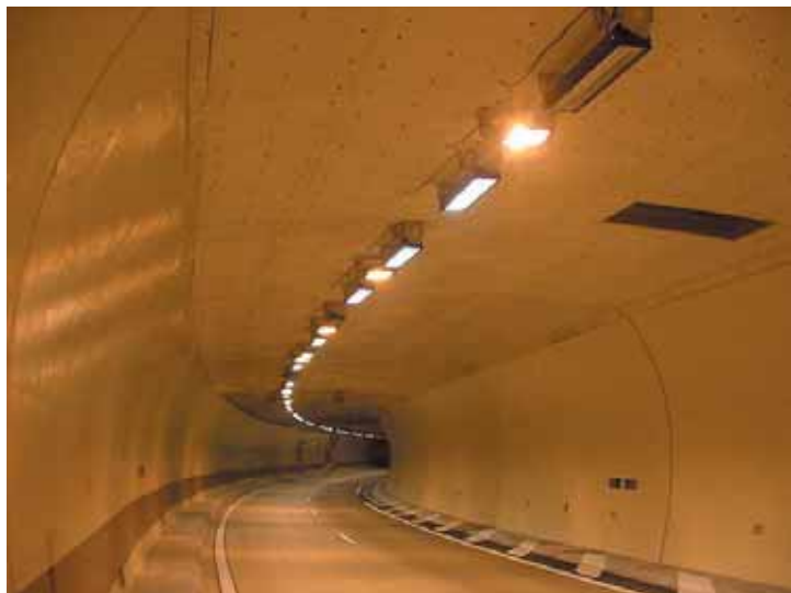
Photo 4 Appareils d'éclairage en tunnel Tunnel lighting appliances
